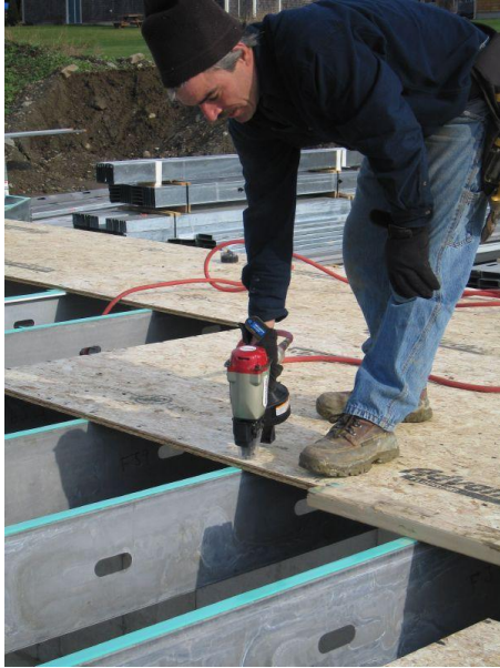
Figura 12. Instalación de las láminas Advantech sobre perfiles con cinta antivibración. (Tomado de: American Steel Frame Services)
