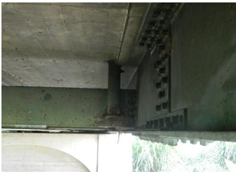
Figura 25. Mecanismos de drenaje deficientes.
