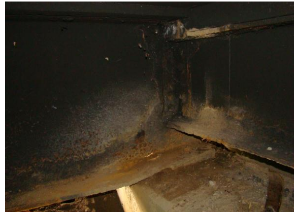
Figura 27. Deformaciones en vigas principales.
