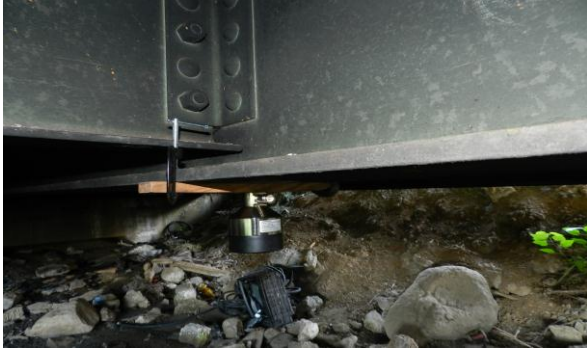
Figura 54. Instalación de sensor SR50A.
