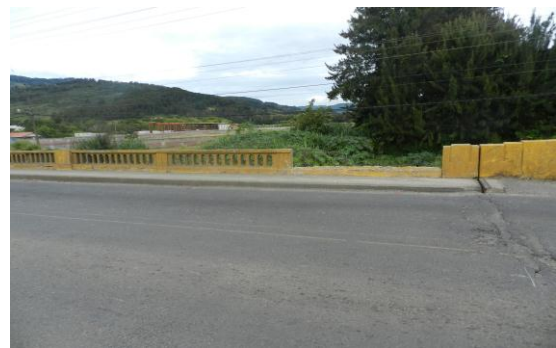
Figura 23. Falta de Barandas.
