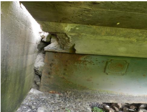
Figura 24. Fatiga en la losa de concreto.
