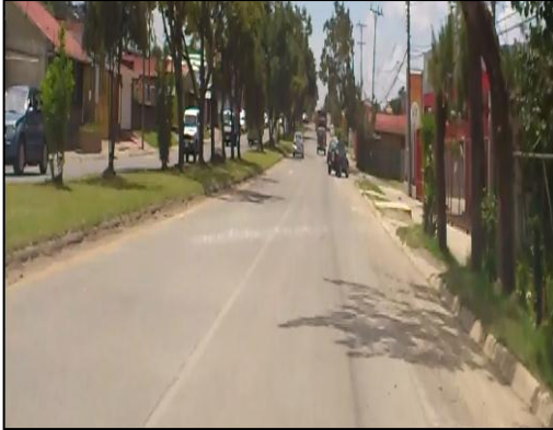
Figura 63. Estado superficie de rodamiento en ruta 10 (Autor,2012).
