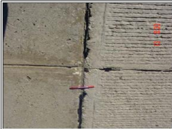
Figura 40. Deficiencia en material de sello (INVIAS, 2006)
