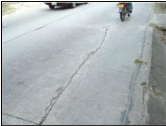
Figura 28. Grieta longitudinal (INVIAS,2006)
