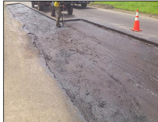
Figura 70. Bordes irregulares en área a bachear (Autor, 2012)
