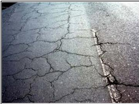
Figura 12. Grieta en bloque. (DIRCAIBEA, 2002)
