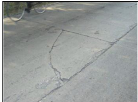
Figura 30. Grietas de esquina (INVIAS,2006)
