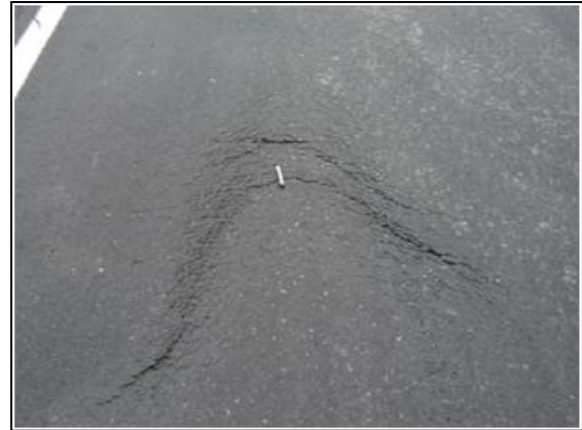
Figura 13. Grieta por desplazamiento. (INVIAS, 2006)
