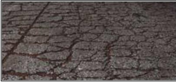
Figura 31. Grietas en losas subdivididas (INVIAS, 2006)
