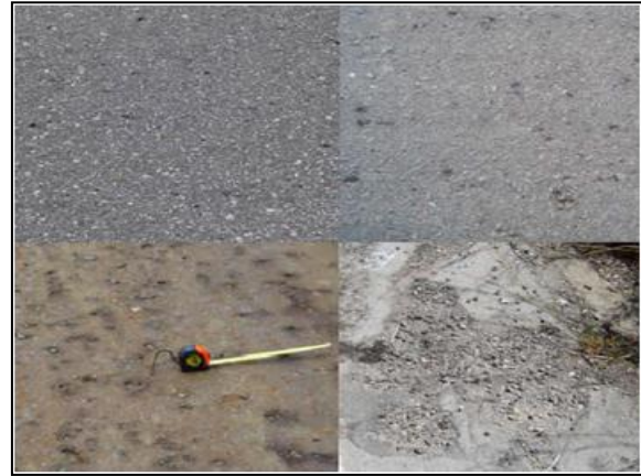
Figura 26. Pérdida de agregado (INVIAS,2006)
