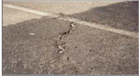
Figura 33. Grietas inducidas (SIECA, 2000)
