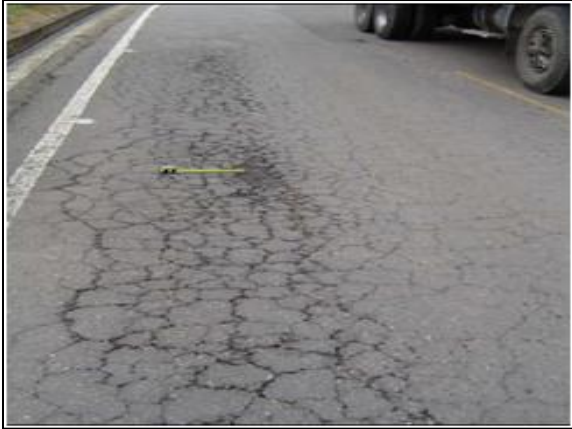
Figura 11. Grieta tipo cuero de lagarto( INVIAS, 2006)
