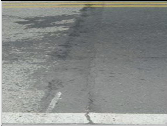
Figura 15. Grieta transversal en junta de construcción.(INVIAS,2006)
