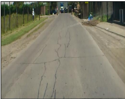
Figura 64. Estado superficie de rodamiento en ruta 231 (Autor,2012).
