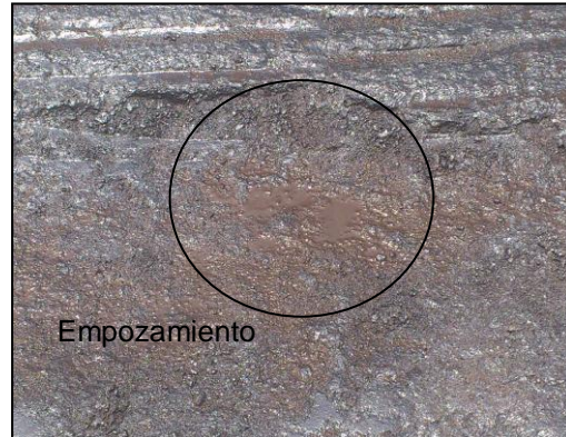
Figura 78. Exceso de emulsión asfáltica (Autor,2012)
