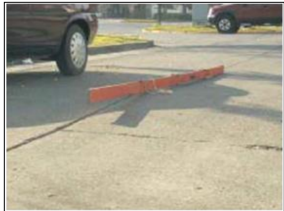
Figura 34. Levantamiento de losas. (INVIAS, 2006)
