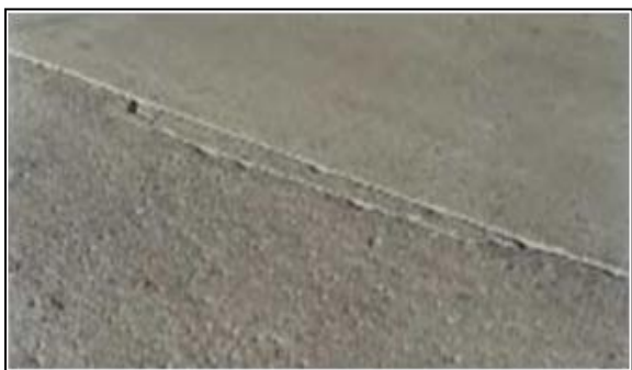
Figura 44. Fisuras por mal funcionamiento de juntas (SIECA, 2010)
