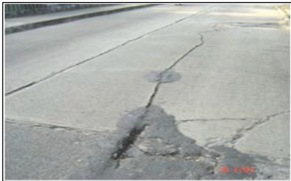
Figura 32. Grietas en bloque. (INVIAS, 2006)
