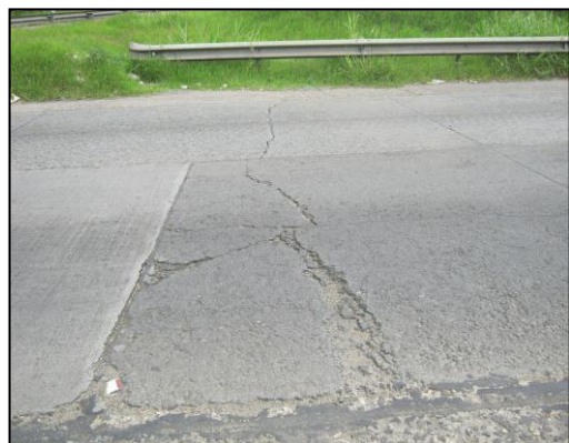
Figura 62. Estado superficie de rodamiento en ruta 2 (Autor, 2012).
