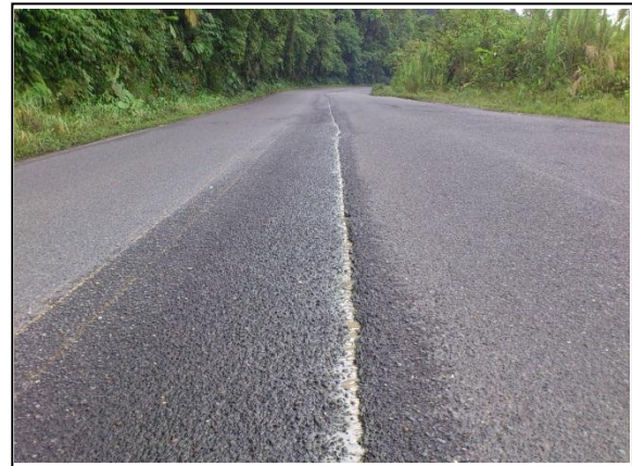
Figura 14. Grieta longitudinal en junta de construcción. (Autor, 2012)
