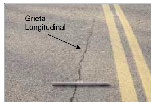
Figura 7. Grieta longitudinal, en centro de la superficie de ruedo. (SIECA, 2010)
