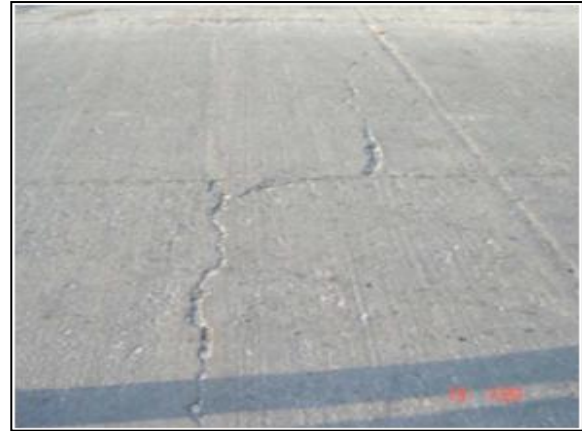
Figura 29. Grietas transversales (INVIAS,2006)
