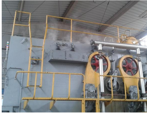
Figura 4.6. Agua que se evapora en los tanques de la lavadora.
