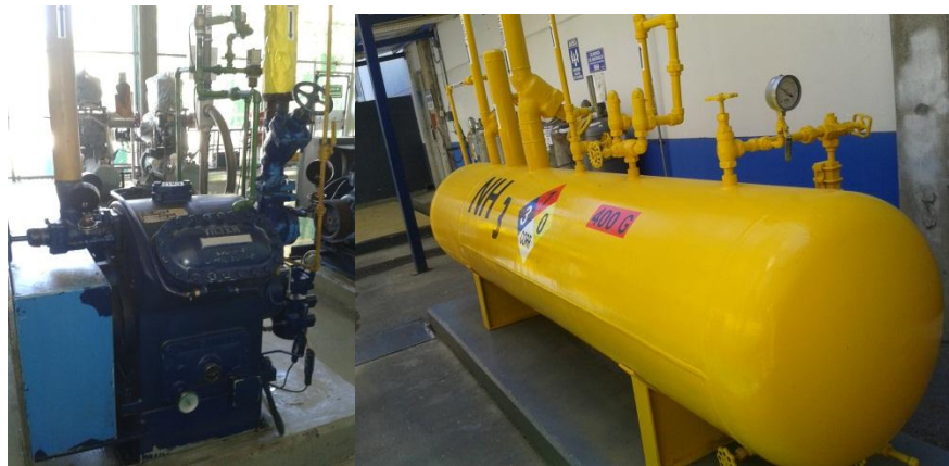
Figura 4.13. Compresor y tanque de líquido del sistema de refrigeración.
