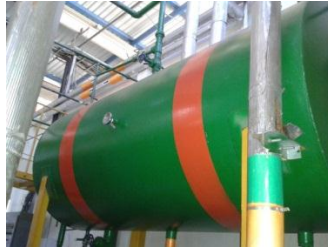
Figura 4.9. Tanque de condensados de 2,6 m 3 .
