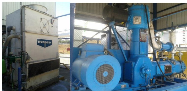
Figura 4.12. Torre de enfriamiento y compresor Francois de 40 Bar.
