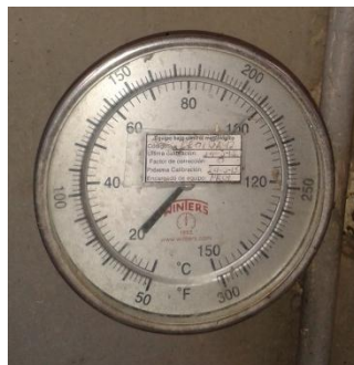
Figura 4.5. Termómetro instalado en el tanque 1 que marca 100 °C.
