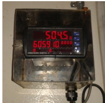
Figura 4.1. Medidor de flujo de vapor.
