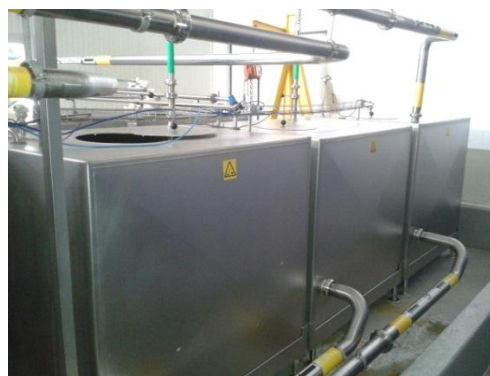
Figura 4.7. Tanques de almacenamiento ALCIP.
