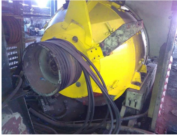
Figura 2.9. Generador principal GE 5GT601C1.
