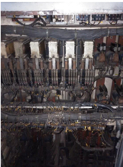
Descripción: Gabinete de control eléctrico
