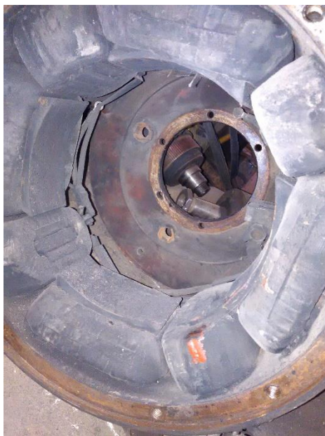
Descripción: Estator de generador auxiliar
