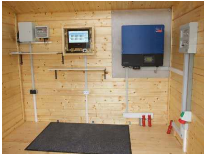
Figura 8-10 La casa técnica del PV Test Station
