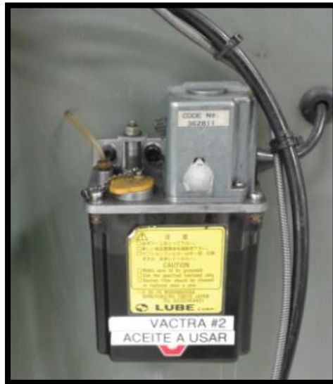
Figura 7. Bomba para lubricación de accionamiento manual
