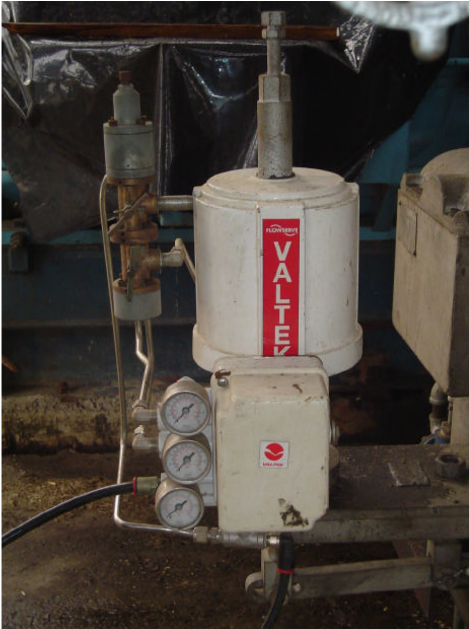
Foto 7.6 Válvula controladora de la entrada de vapor.
