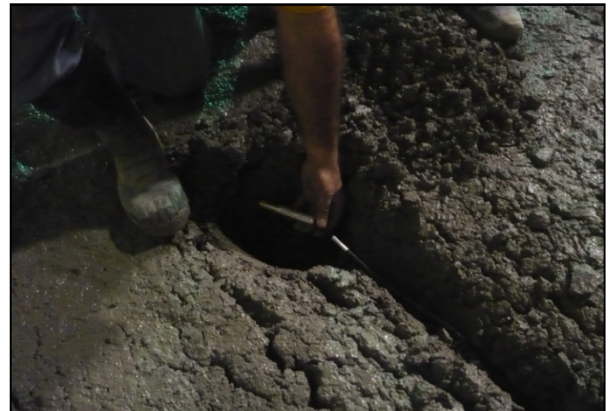
Figura 26. Instalación de un termómetro. Fuente Departamento de Auscultación de Obras de PH Pirris, ICE.
