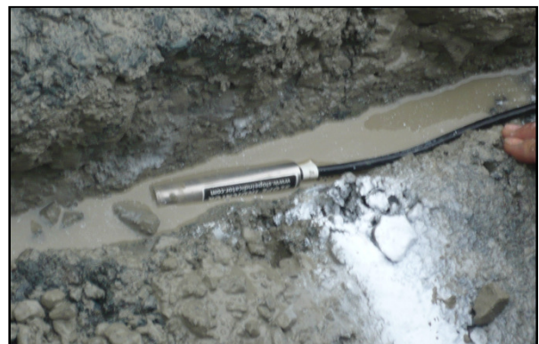
Figura 43. Instalación de un termómetro sin protección. Fuente Departamento de Auscultación de Obras, ICE, 2009.
