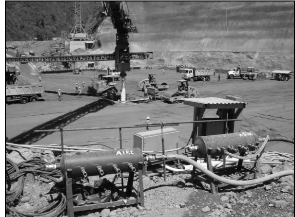
Foto 53. Ubicación de suministros de agua, aire y electricidad, vista aguas arriba de la presa
