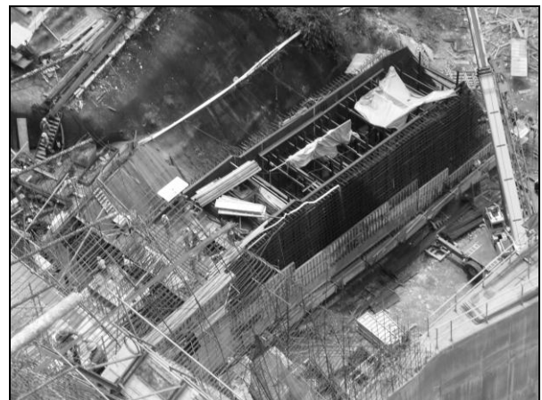
Foto 80. Canal de salida de la descarga de fondo, aguas abajo de la presa, octubre 2010
