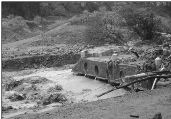
Foto 88. Vado colapsado por la salida de una quebrada, "Sitio Presa", 30 de mayo 2008
