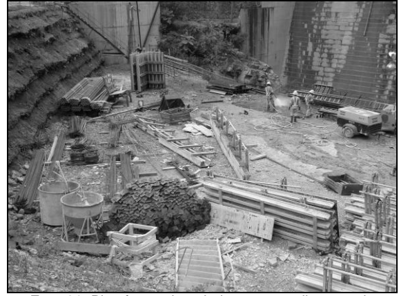
Foto 32. Plataforma de trabajo, aguas arriba, para la organización y preparación de la formaleta por colocar en la presa
