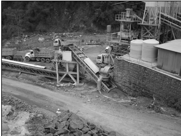
Foto 28. Punto de salida de la banda en la planta de RCC (zona de difícil mantenimiento)
