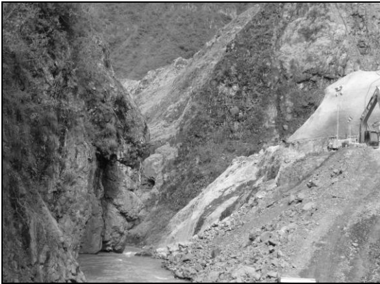
Foto 71. Zona donde se va a ubicar la contra presa, aguas abajo de la presa, octubre 2009
