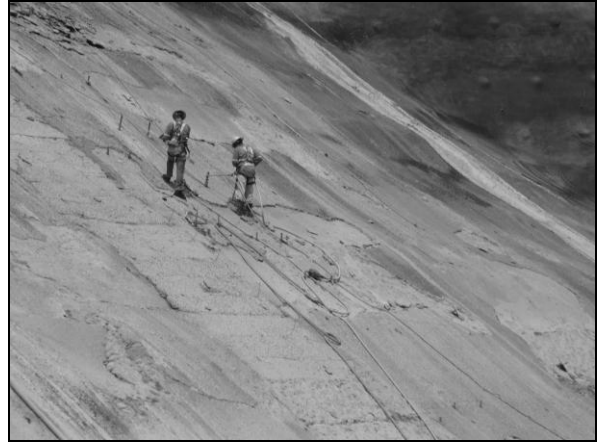
Foto 58. Levantamiento de zonas dañadas, en la margen izquierda de la presa, julio 2009
