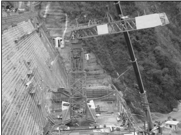
Foto 49. Instalación de grúa torre POTAIN MD1100 en la rápida del vertedor, febrero 2010
