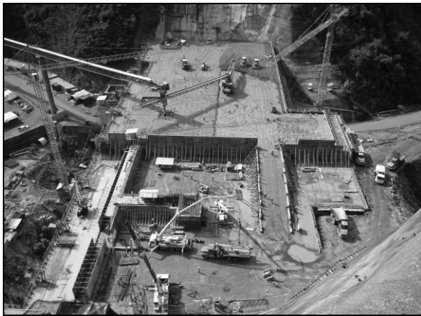
Foto 62. Construcción de galería de drenaje en la elevación 1140 msnm y sistema de hiper bloques, octubre 2009
