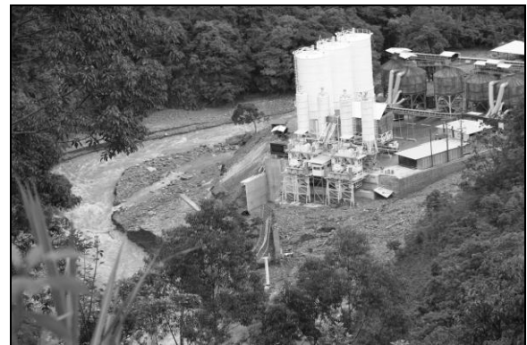
Foto 89. Daños ocasionados en la planta de RCC, "Sitio Presa", 30 de mayo 2008
