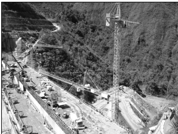
Foto 50. Funcionamiento de las tres grúas torre, vista margen derecha de la presa, febrero 2010
