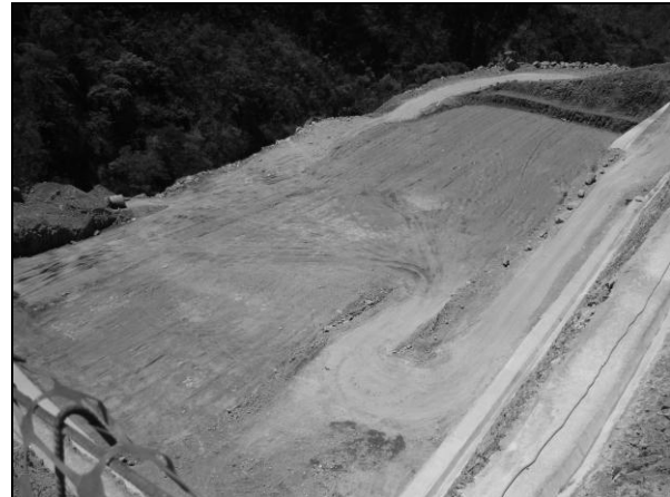
Foto 12. Aprovechamiento del tajo ya explotado, para colocar material de relleno (final), marzo 2010
