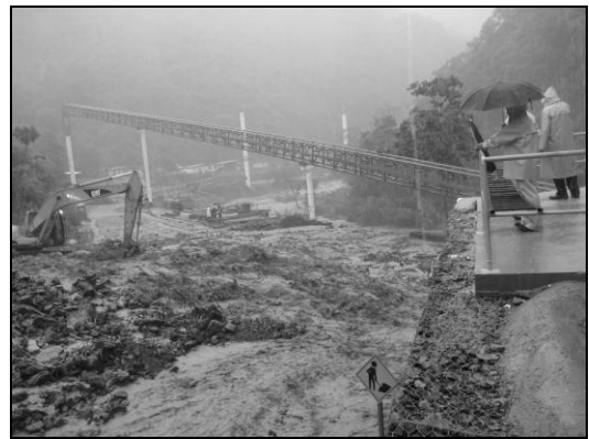
Foto 81. Afectación de una quebrada a la planta de RCC, “Sitio Presa”, 29 de mayo 2008
