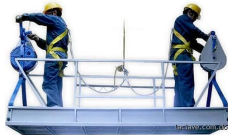
Figura 53. Sistema combinado entre andamio colgante y línea de vida. (Fuente: laclave.com)
