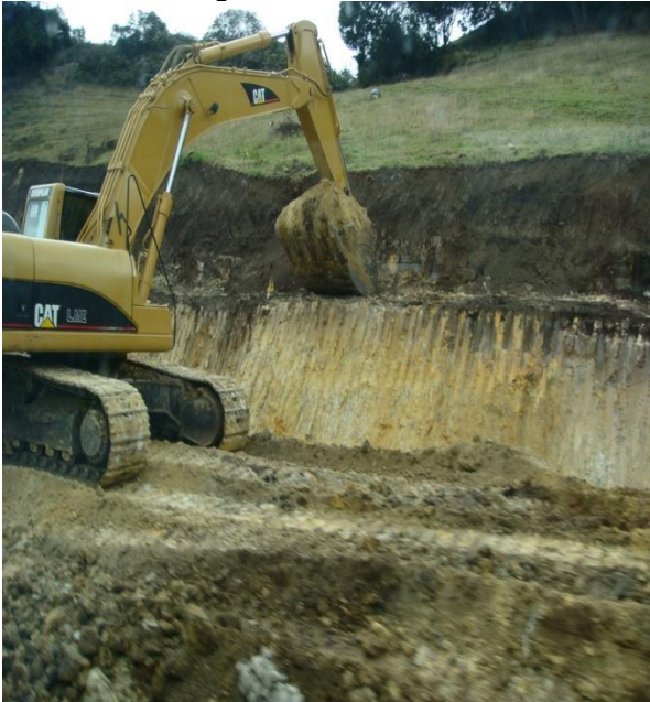
Figura 16. Modificación geométrica del talud. (Ref. Internet 3)
