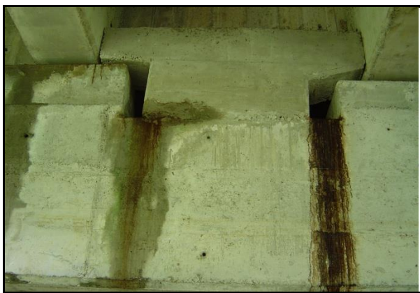
Figura 120. Filtración de agua a través de las juntas selladas.
