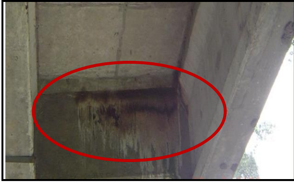
Figura 50. Filtración de agua a través de la losa (eflorescencia).
