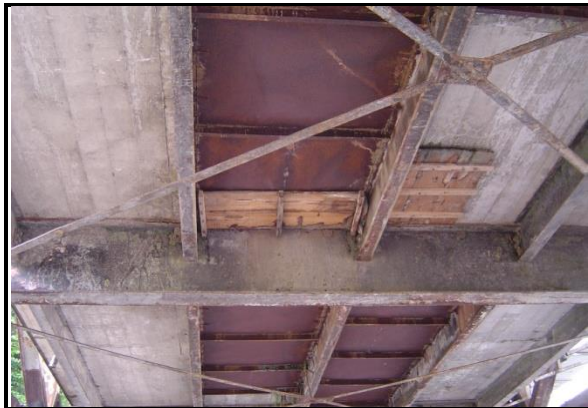
Figura 74. Detalle de las "reparaciones" efectuadas en la losa.
