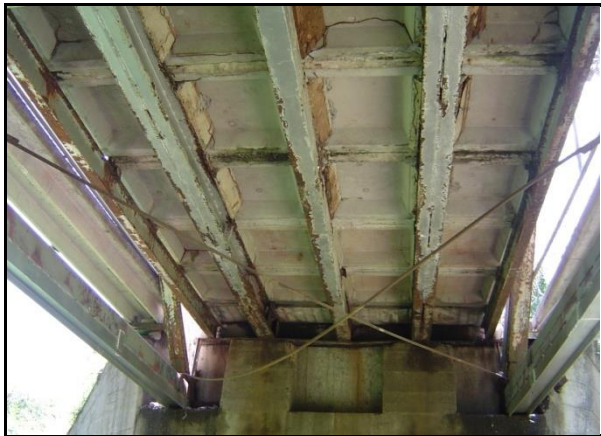
Figura 146. Detalle de la corrosión y oxidación de las vigas.
