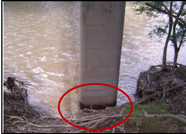
Figura 132. Socavación en la pila.
