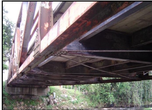
Figura 69. Vista inferior, además del detalle observado de corrosión y oxidación en los elementos de acero.
