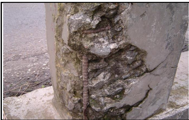
Figura 41. Exposición del acero en las barandas de concreto.
