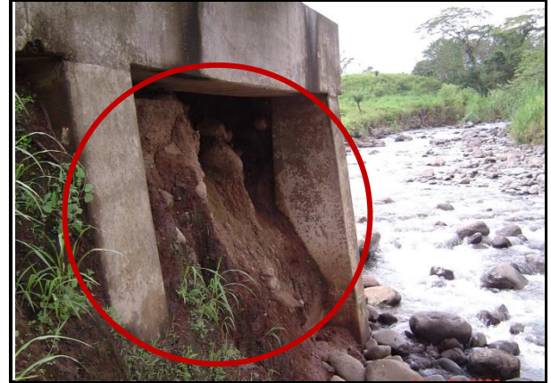
Figura 66. Detalle del nivel de socavación y la falta de protección ("pantalla").
