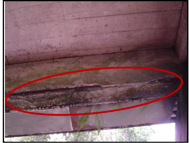
Figura 16. Problemas de descascaramiento del concreto en vigas
