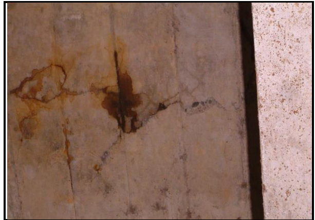
Figura 165. Detalle de grietas en la losa, así como la filtración de agua.
