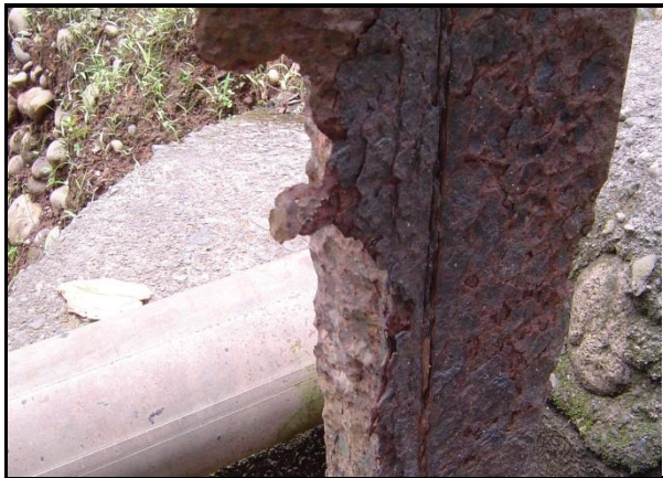
Figura 161. Pérdida de sección en los postes de la baranda.
