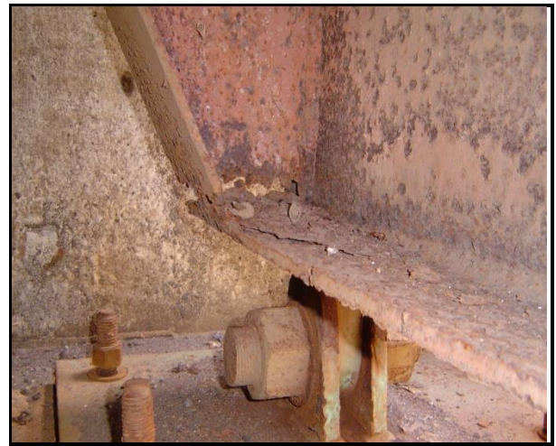
Figura 126. Corrosión y oxidación en pernos y placas de los apoyos.
