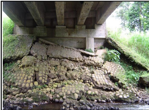
Figura 115. Detalle del mal estado de la escollera de uno de los bastiones de concreto.
