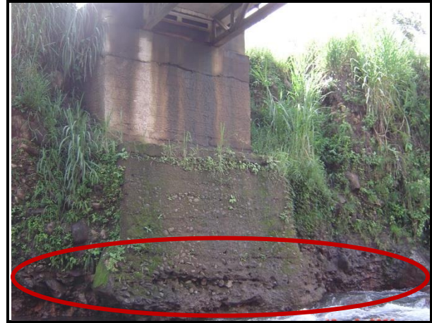
Figura 62. Problemas de socavación en base del bastión y en márgenes del río.
