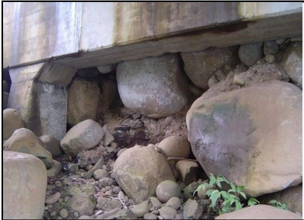
Figura 168. Pérdida del talud, debido a la falta de una pantalla que retenga el material.
