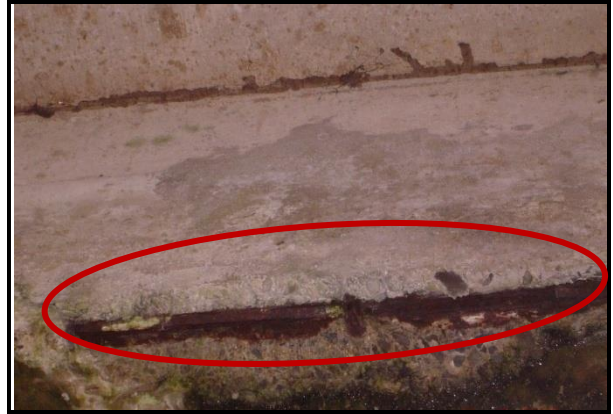
Figura 42. Pérdida del recubrimiento de concreto y con ello la exposición severa del acero.
