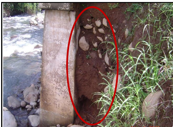
Figura 65. Erosión y socavación alrededor de la columna del marco del bastión.
