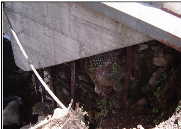
Figura 112. Representación de la pérdida del talud de protección.
