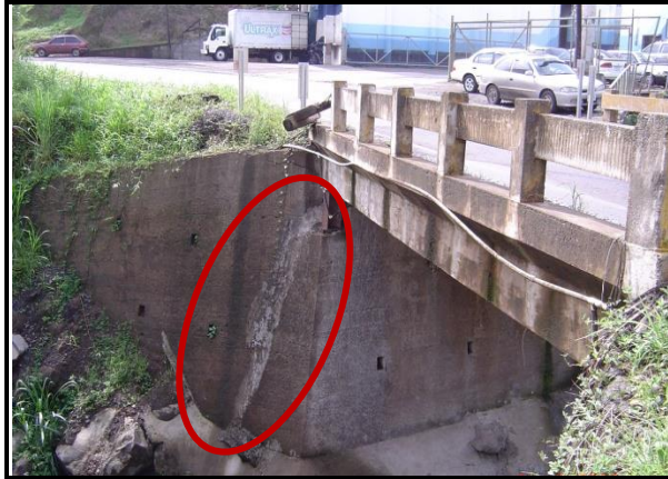
Figura 80. Detalle de la grieta provocada por el asentamiento diferencial.
