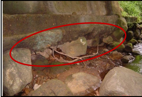
Figura 32. Problemas de socavación en los bastiones.
