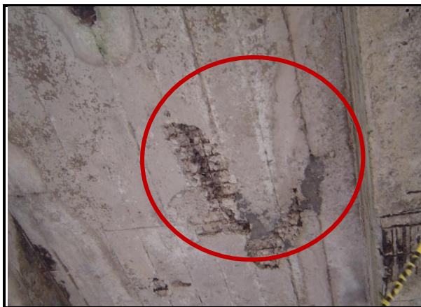
Figura 56. Losa fracturada, se observa la exposición del acero de refuerzo.
