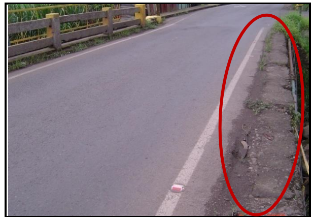
Figura 52. Vista panorámica. Además del detalle de faltante de barandas.
