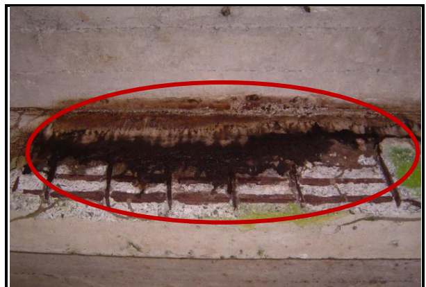
Figura 44. Acero longitudinal y transversal expuesto.
