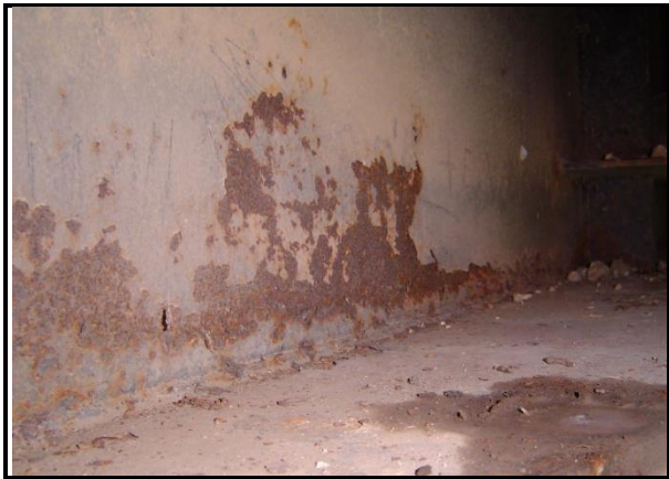
Figura 136. Corrosión-oxidación y falta de mantenimiento en las vigas principales, específicamente las vigas laterales.
