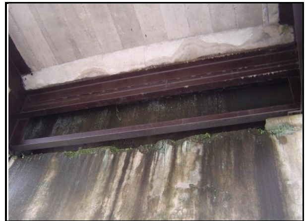
Figura 156. Filtración de agua a través de las juntas.
