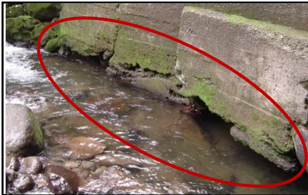
Figura 24. Socavación en bastión.
