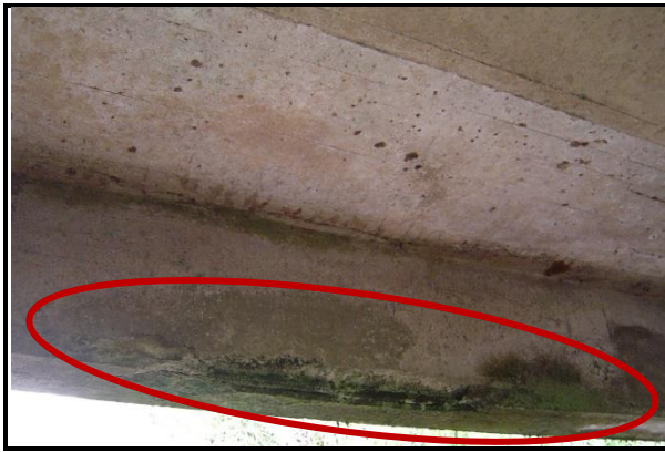
Figura 36. Descascamiento del concreto.
