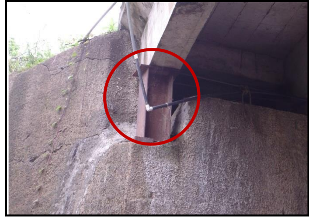
Figura 82. Colocación de vigas de acero que funciona como apoyo para levantar las vigas de concreto.
