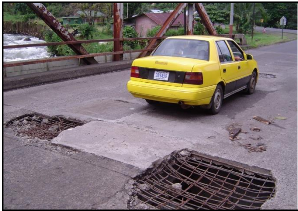
Figura 73. Agujeros en la losa, así como la presencia de bache y el acero expuesto.
