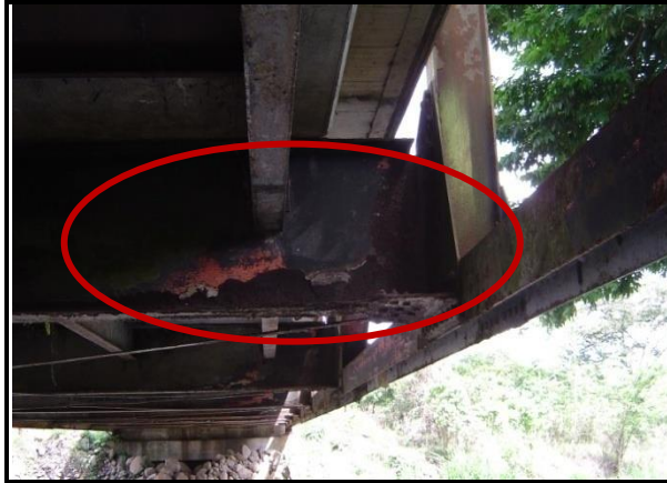
Figura 72. Pérdida de área en las vigas secundarias, producto de la corrosión.
