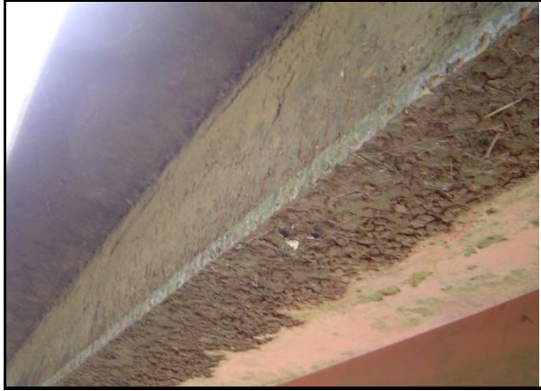
Figura 160. Vigas laterales de acero con oxidación-corrosión.
