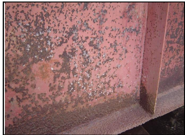
Figura 124. Representación de la corrosión y oxidación en la viga principal de acero.
