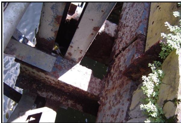
Figura 147. Alto grado de corrosión en las vigas transversales
