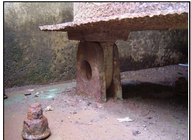
Figura 127. Ausencia del perno principal que une la viga con la placa.
