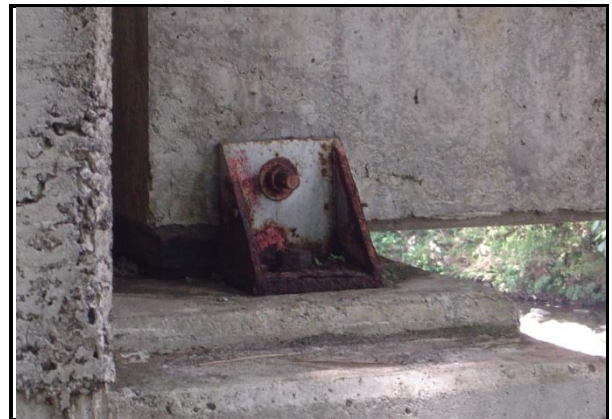
Figura 109. Detalle de corrosión y oxidación en los apoyos.
