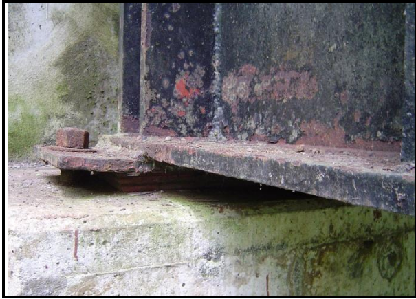
Figura 135. Corrosión y oxidación en los apoyos fijos.
