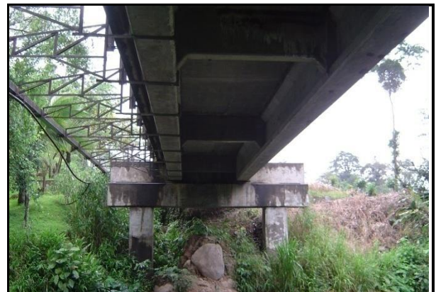
Figura 48. Vista inferior, así como detalles de vigas principales, viga diafragma y pila.
