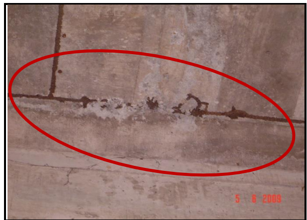
Figura 22. Exposición del acero, provocado por el descascamiento entre la losa y al viga diafragma.
