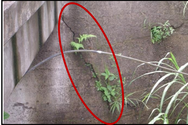
Figura 19. Grieta ubicada en el aletón del bastión.
