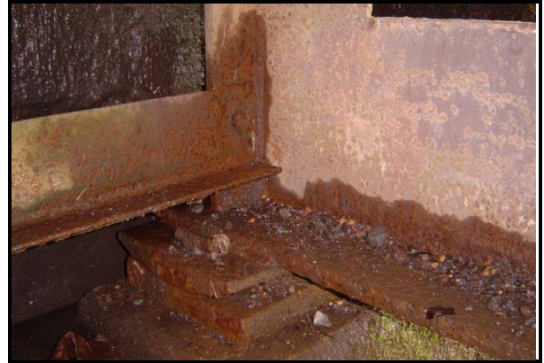
Figura 151. Problemas de corrosión y oxidación en los apoyos y armadura.
