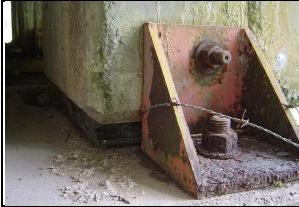
Figura 107. Corrosión y oxidación en los pernos y placas de los apoyos.
