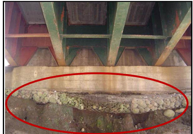
Figura 131. Socavación en el talud del bastión No.1.
