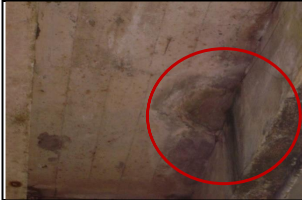
Figura 16. Filtración de agua en la losa y viga, y muestras de eflorescencia.
