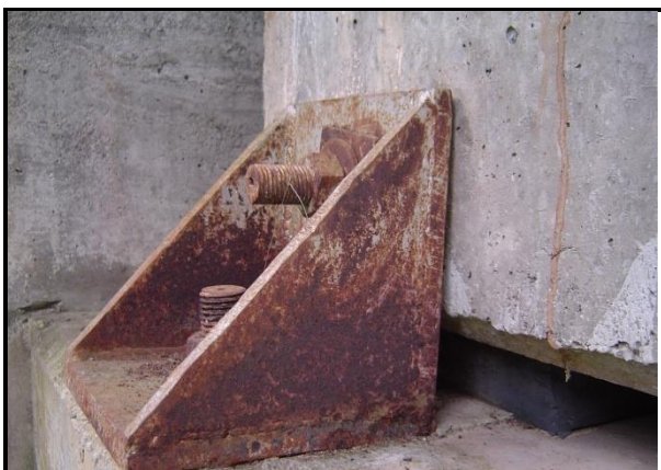
Figura 116. Corrosión y oxidación en los apoyos.
