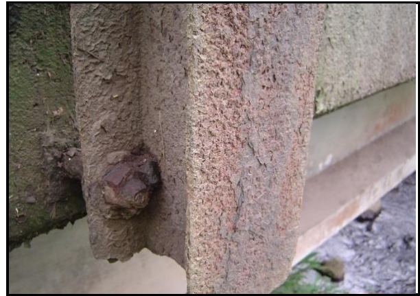
Figura 86. Detalle de corrosión y oxidación de los postes en la baranda flexbeam.
