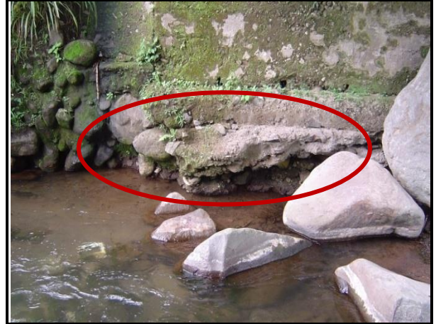
Figura 57. Problemas de socavación en los estribos.
