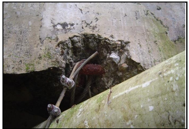
Figura 30. Vigas en mal estado, producto del uso inadecuado.
