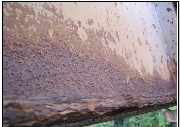
Figura 166. Corrosión y oxidación en las vigas principales.
