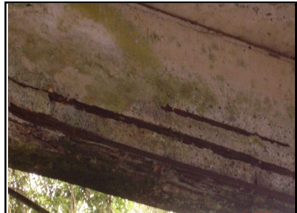
Figura 17. Acero expuesto, producto de la pérdida de recubrimiento.
