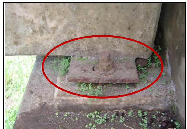
Figura 49. Corrosión y oxidación en apoyos.
