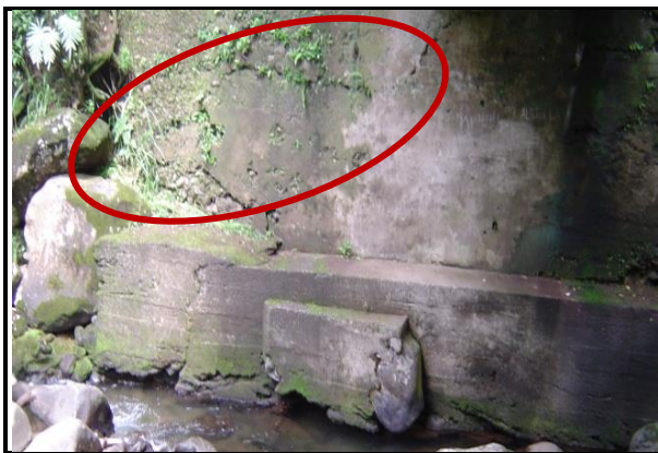
Figura 25. Grieta provocada por asentamiento diferencial.
