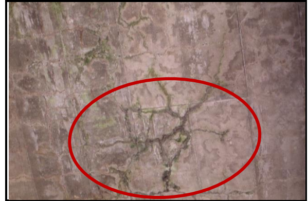
Figura 75. Detalle de las grietas presentes en la losa de concreto.
