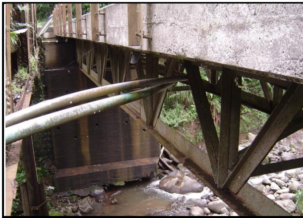
Figura 140. Desgaste de las cerchas.
