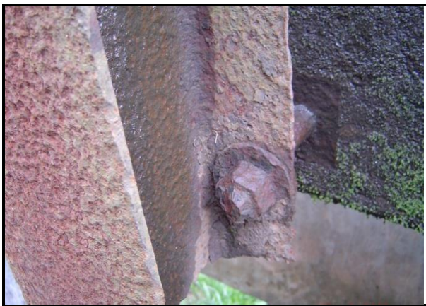
Figura 51. Corrosión y oxidación en las barandas flexbeam.
