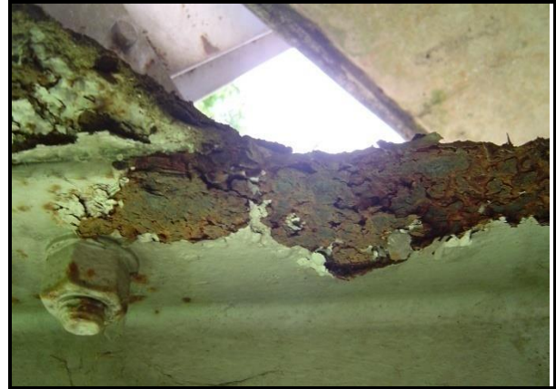
Figura 79. Corrosión y oxidación en las vigas principales de acero.
