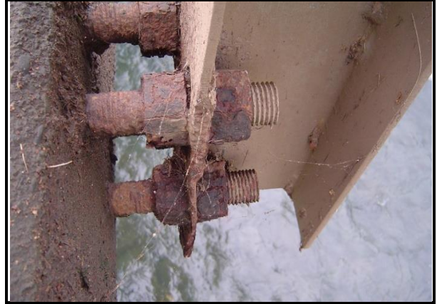
Figura 164. Corrosión y oxidación de las barandas tipo flexbeam.
