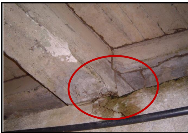
Figura 46. Grietas en la viga cabezal, en el punto de apoyo.
