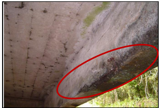
Figura 31. Desgaste del recubrimiento en las vigas de concreto
