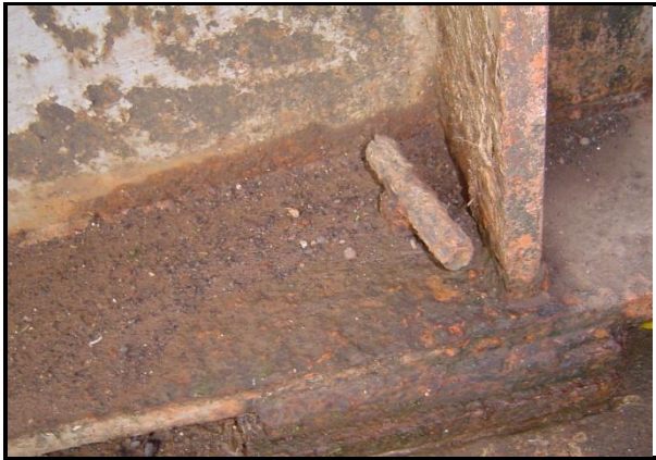
Figura 60. Detalle de corrosión y oxidación de los apoyos.
