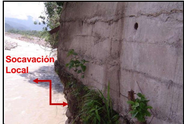
Figura 101. Socavación en el muro ubicado en el bastión No.1.
