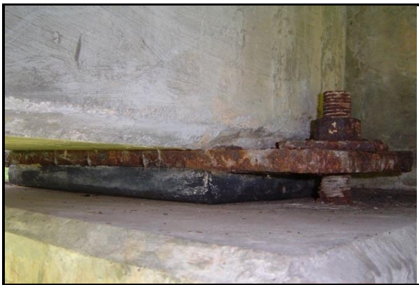
Figura 77. Corrosión y oxidación en apoyos fijos.
