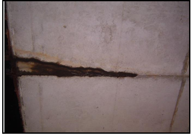
Figura 137. Filtración de a través de la losa.
