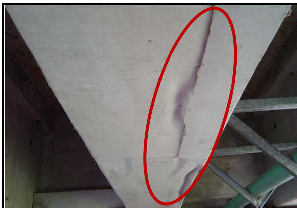
Figura 119. Deformación en vigas postensadas.
