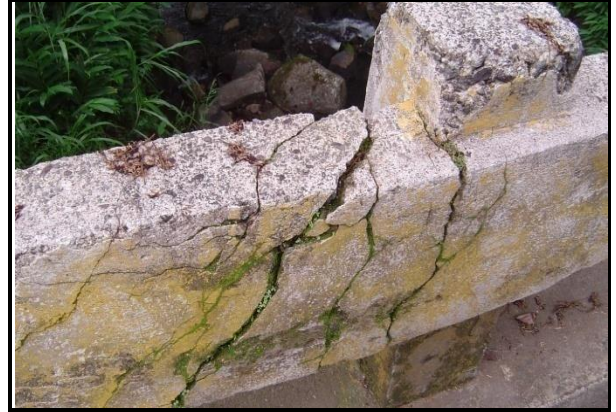
Figura 29. Grado de daño de las barandas de concreto.
