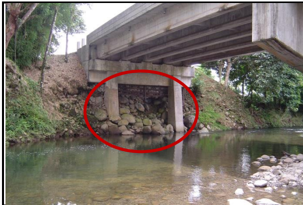
Figura 111. Detalle del mal soporte usado para la retención de material.
