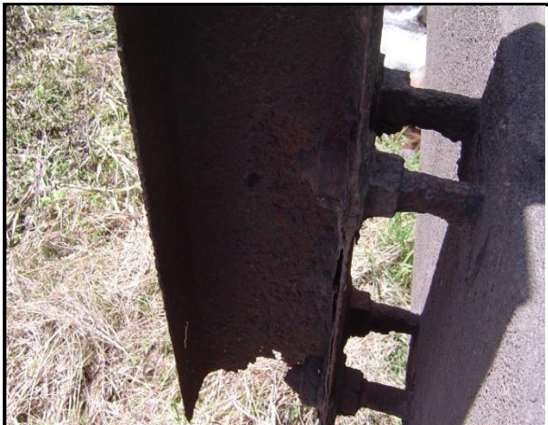
Figura 93. Corrosión y oxidación de las barandas.
