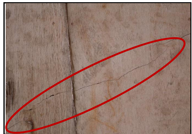
Figura 98. Detalle de fisuras presentes en la viga cajón.
