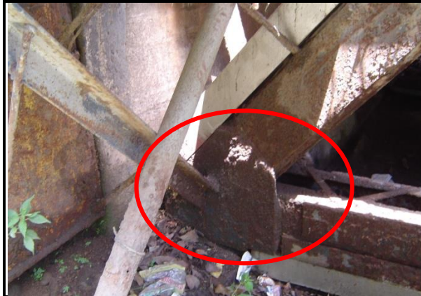
Figura 145. Corrosión y oxidación en el punto de apoyo de la estructura.
