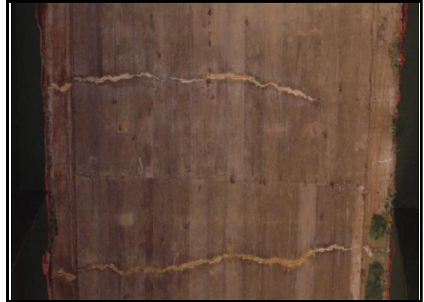
Figura 130. Vista inferior de la losa, con problemas de grietas y eflorescencia
