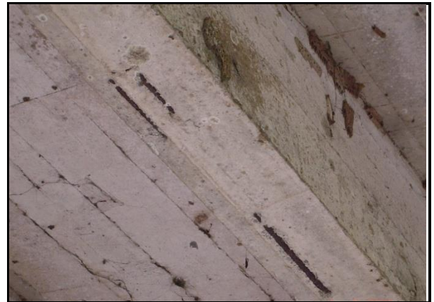
Figura 83. Acero Expuesto en las vigas principales de concreto.
