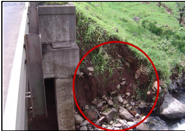
Figura 64. Pérdida de material de relleno lateral.
