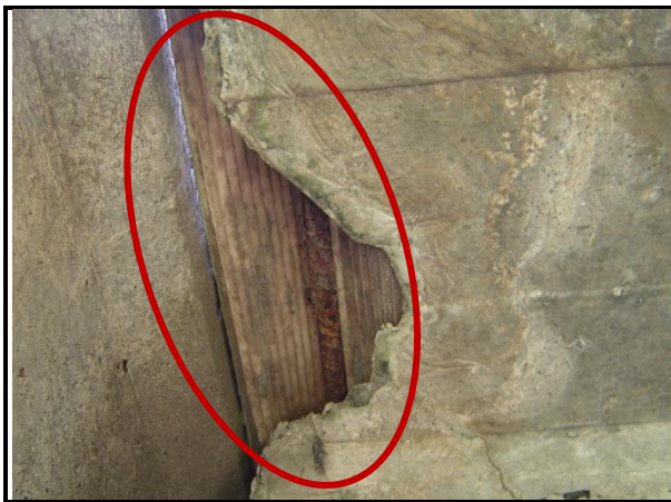
Figura 129. Acero expuesto y pérdida de condición normal de la junta.
