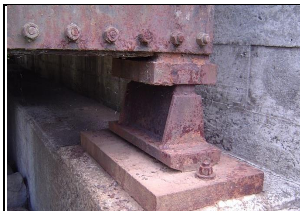
Figura 71. Detalle de corrosión y oxidación en el apoyo expansivo tipo patín.
