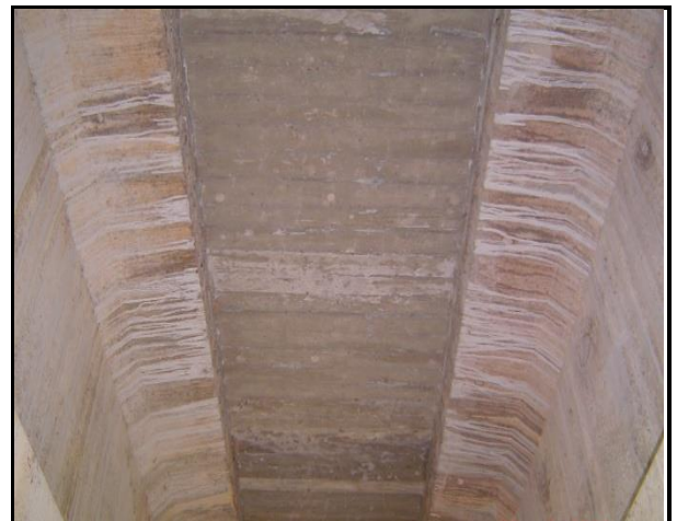
Figura 106. Eflorescencia en zonas de la viga principal.
