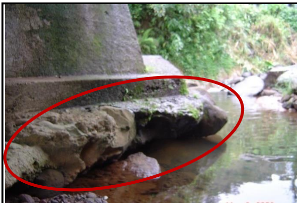
Figura 37. Problemas de socavación.
