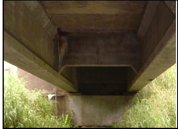
Figura 85. Vista inferior, con detalle del buen estado de las vigas de concreto.
