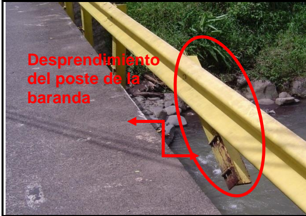
Figura 157. Deformación de la baranda tipo flexbeam.
