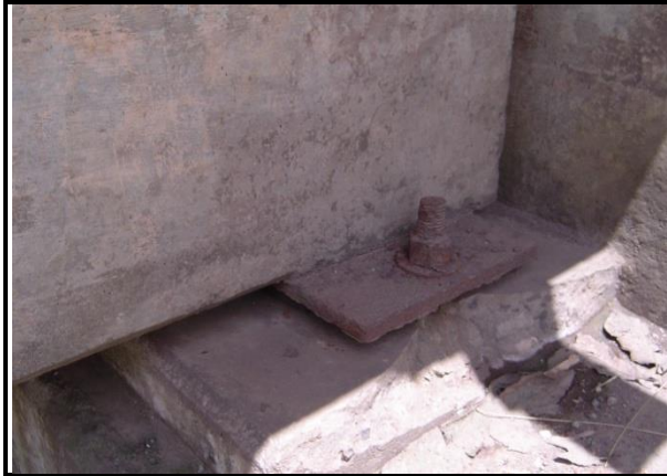
Figura 92. Corrosión y oxidación en los pernos y platina de los apoyos.
