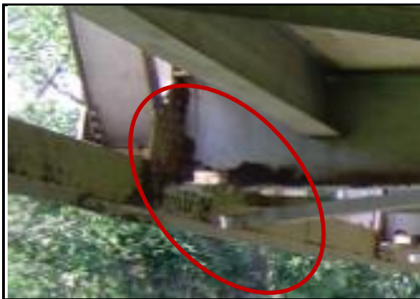
Figura 78. Presentación de la rotura de elementos en el sistema de arriostramiento.
