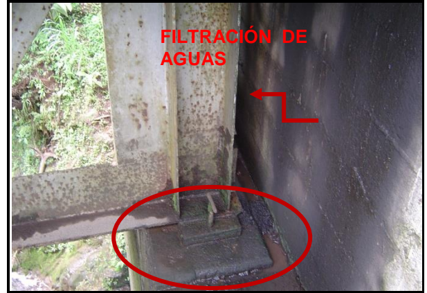
Figura 141. Falta de mantenimiento de los apoyos fijos, así como la filtración de agua por medio de las juntas.
