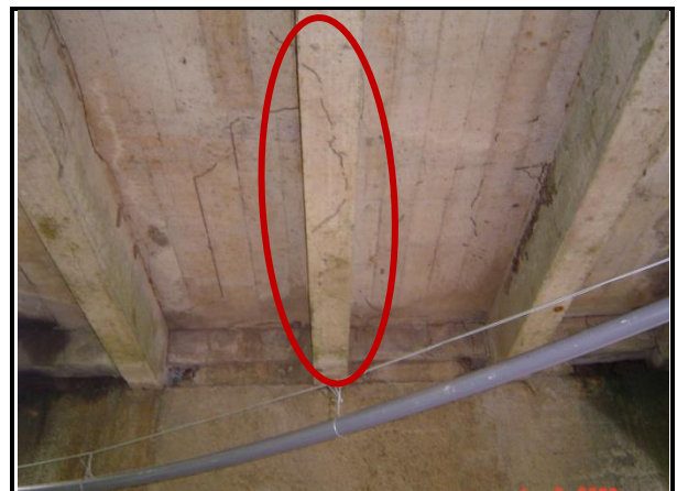
Figura 18. Grietas en las vigas de concreto.
