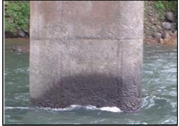
Figura 169. Desgaste del cuerpo de la pila, provocado por la acción del agua.
