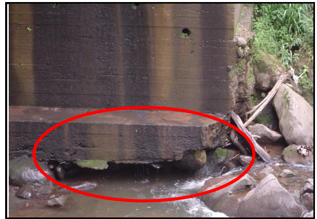
Figura 142. Problemas de socavación en la base del bastión.
