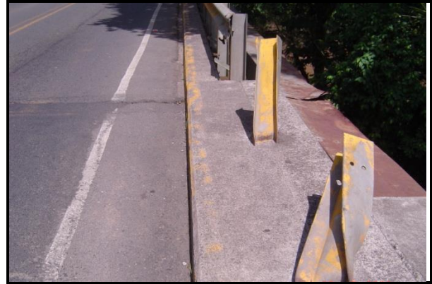
Figura 123. Detalle de la falta de mantenimiento de las barandas tipo flexbeam.
