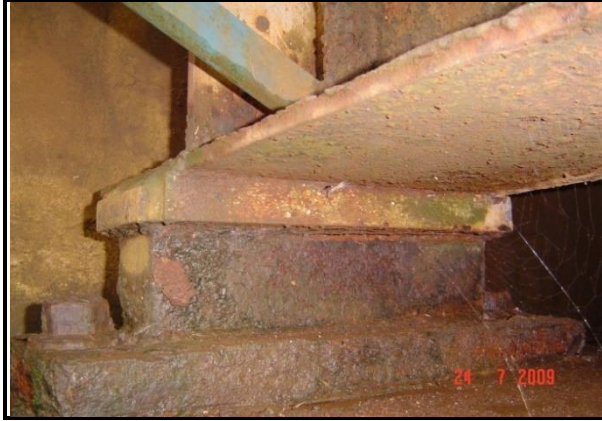
Figura 167. Corrosión y oxidación de los apoyos fijos en la estructura.
