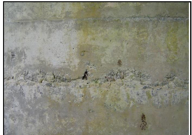
Figura 105. Nidos de piedra presentes en la viga cabezal del bastión.
