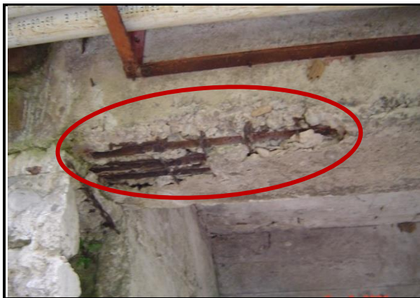
Figura 55. Descasacamiento del concreto y exposición del acero.
