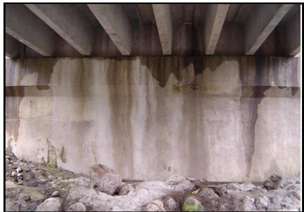
Figura 95. Filtración de agua, debida a la deformación o faltante en las juntas.
