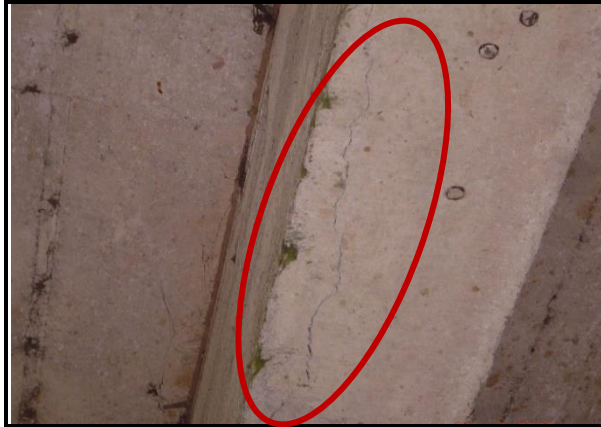
Figura 45. Presencia de grietas en las vigas principales
