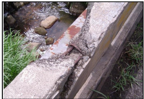
Figura15. Barandas de concreto con exposición del acero
