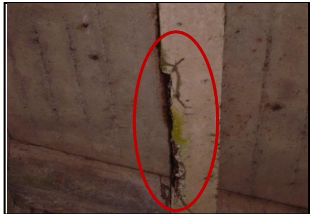
Figura 43. Descascaramiento del concreto
