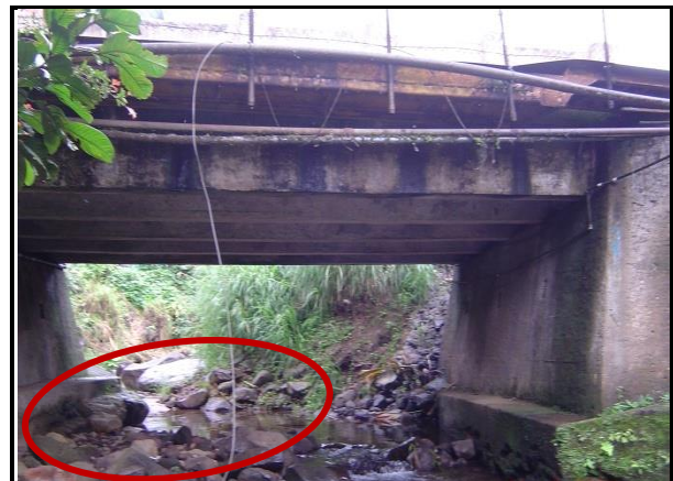
Figura 34. Vista Lateral del puente sobre Río Marín, además de acumulación del material granular en un extremo.
