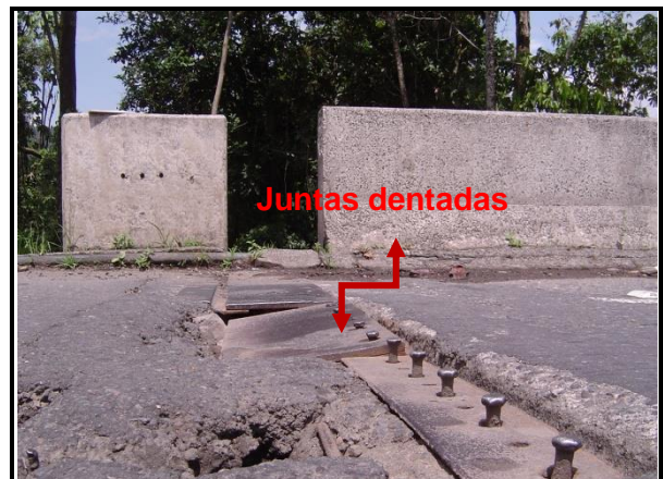
Figura 102. Deterioro de las juntas dentadas.
