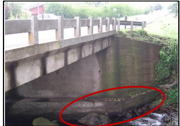
Figura 38. Vista panorámica del puente sobre el Río Zapotal, además del detalle de socavación en el bastión No.2.
