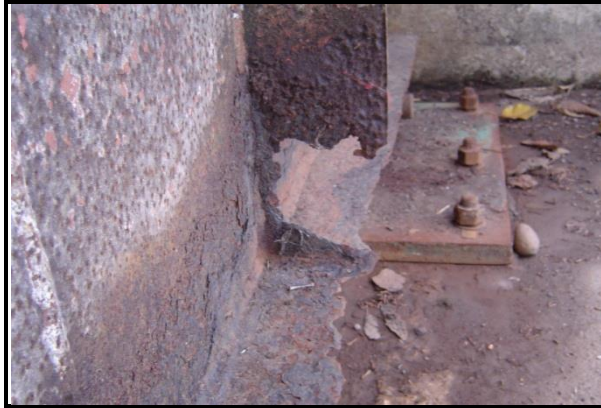
Figura 125. Pérdida de sección en las vigas principales, producto de los problemas de corrosión.
