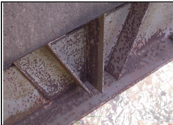
Figura 61. Detalle de cerchas, específicamente de la falta de mantenimiento.
