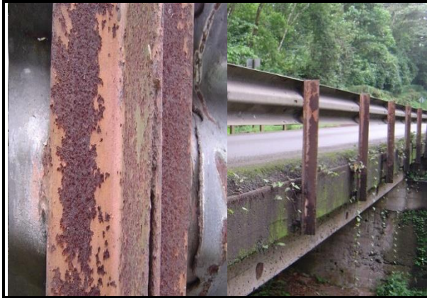
Figura 23. Problemas de oxidación, corrosión y pintura en las barandas flexbeam.
