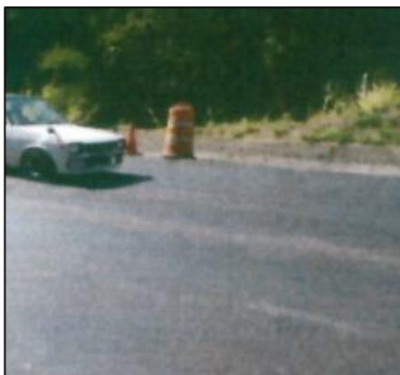
Fig. 47. Falta de señalización en ciertos tramos, ruta 2.
