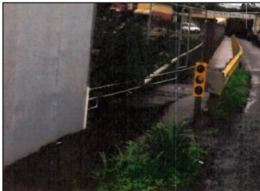
Fig. 101. Presencia de vegetación a la entrada del puente.
