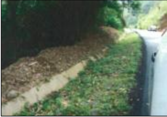
Fig.15. Vegetación invadiendo el sistema de drenaje, Quebrada Grande.
