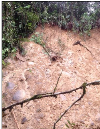
Fig. 151. Pendientes fuertes de los taludes.
