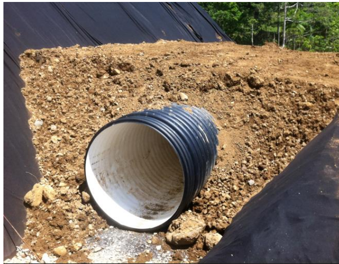
Figura 5. Tramo de Tubería de Conducción, donde muestra la cobertura de la tubería.
