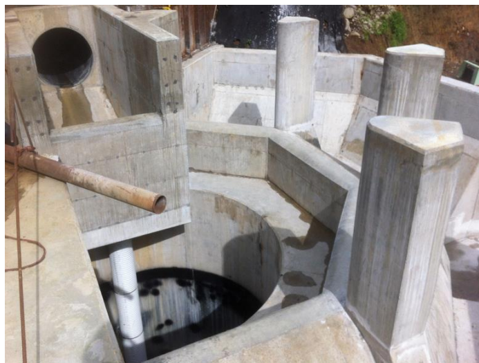
Figura 17. Cámara de Carga con obra gris concluida. Tomada el 14 de Septiembre de 2012.
