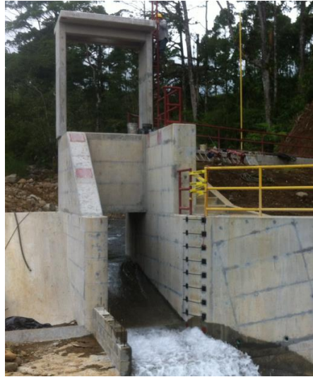
Figura 12. Descarga de fondo termianda junto con Marco de Izaje compuerta JC1.
