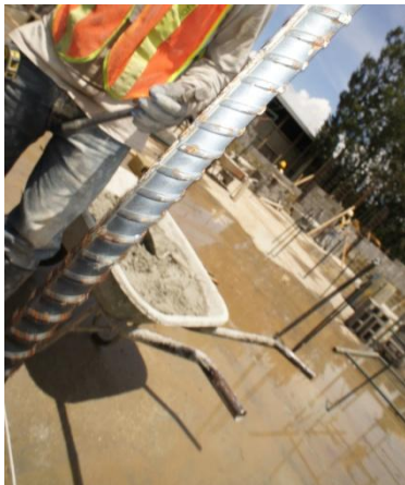
Figura 30. Superficie de la armadura en sitio. (Fuente: Ingeniería, Recope)
