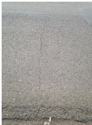
Figura 7. Grieta transversal de baja severidad. Fuente: Elaboración propia del autor.
