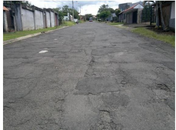
Parches de alta severidad.
