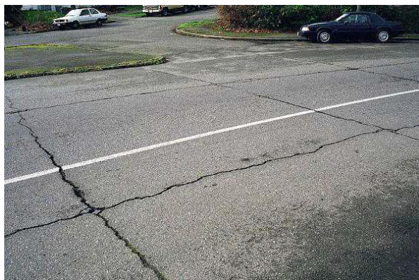
Figura 6. Grieta por reflexión de junta de severidad media. Fuente: (Rodríguez, 2009)
