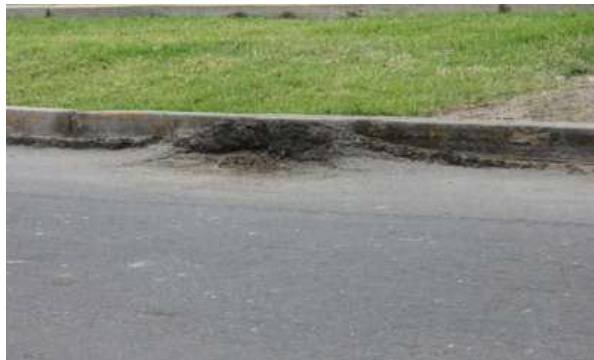
Figura 14. Hinchamiento de severidad alta. Fuente: (Rodríguez, 2009)
