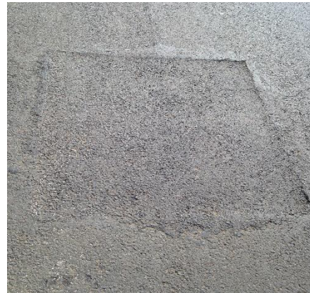
Figura 19. Bache de severidad baja. Fuente: Elaboración propia del autor.
