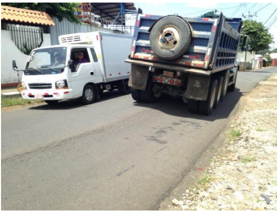
Depresión de alta severidad.
