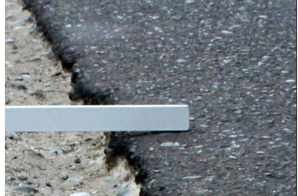
Figura 18. Desnivel carril-berma de severidad alta. Fuente: (Rodríguez, 2009)
