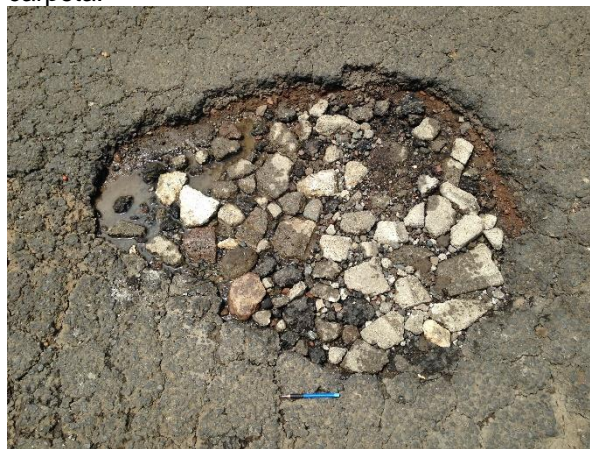
Figura 15. Bache de severidad alta. Fuente: Elaboración propia del autor.
