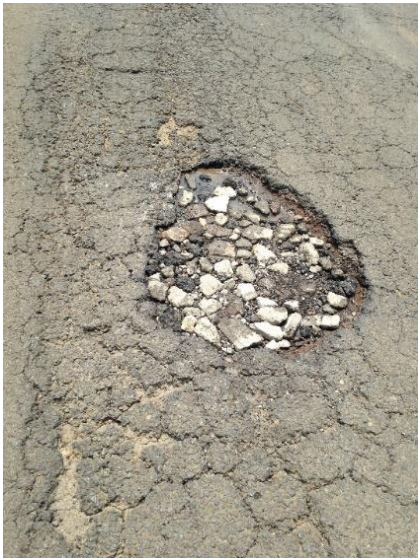
Bache de alta severidad.
