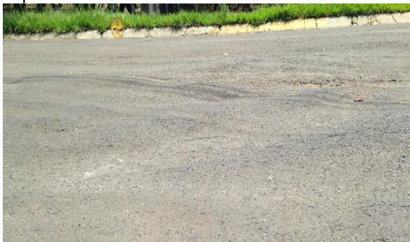
Figura 10. Corrugación de severidad alta. Fuente: Elaboración propia del autor.
