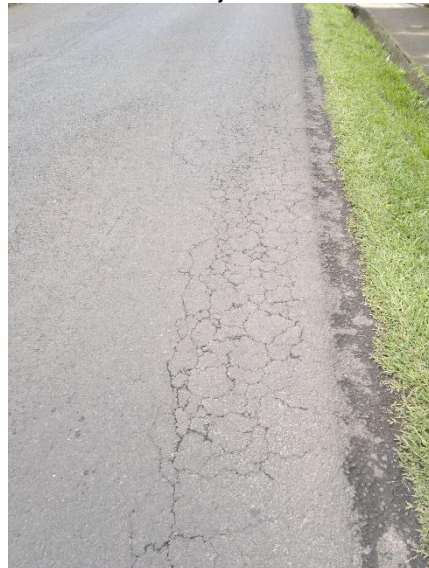
Figura 12. Ahuellamiento de severidad baja. Fuente: Elaboración propia del autor.
