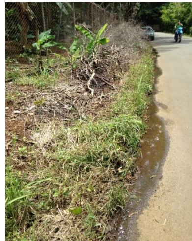
Figura 40. Cunetas naturales obstruidas en Calle Primaria El Pasito
