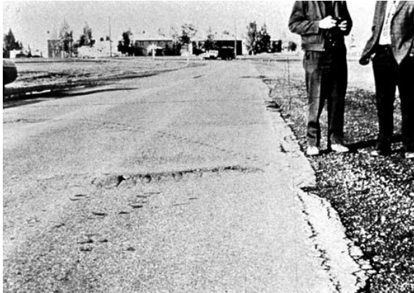
Figura 9. Abultamiento y hundimiento de severidad media. Fuente: (ASTM, 2014)
