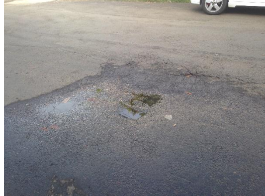
Figura 11. Depresión de severidad alta. Fuente: Elaboración propia del autor.
