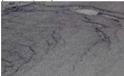
Figura 8. Grieta parabólica de alta severidad. Fuente: (Castro, 2013)
