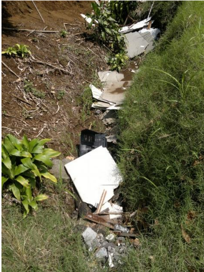
Figura 38. Cunetas naturales obstruidas en Calle Conector Rosales-Cootaxa.
