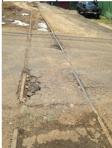
Figura 21. Cruce de línea férrea de severidad alta. Fuente: Elaboración propia del autor.
