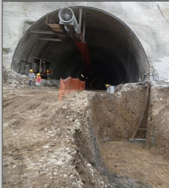
Fotografía 11. Colocación de los hastiales del arco, para continuar con la excavación del banco inferior
