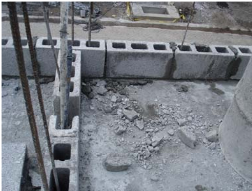
Figura 12. Residuos de mampostería
