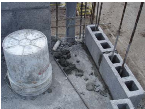
Figura 13. Residuos de mortero de pega de bloques
