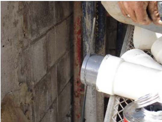
Figura 17. Residuos de tubería PVC
