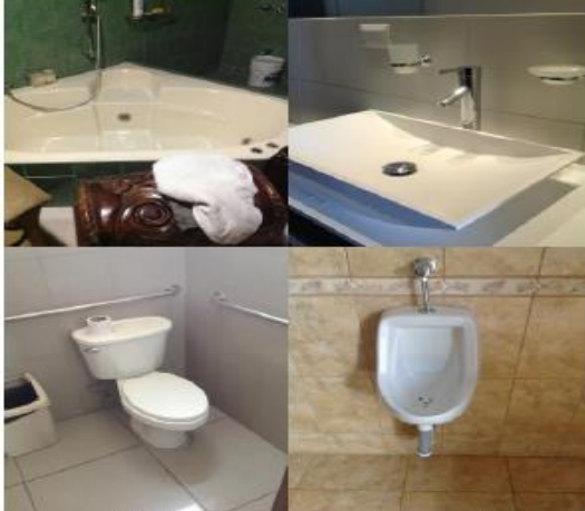
Imagen 1. Diferentes aparatos sanitarios de las edificaciones estudiadas.
