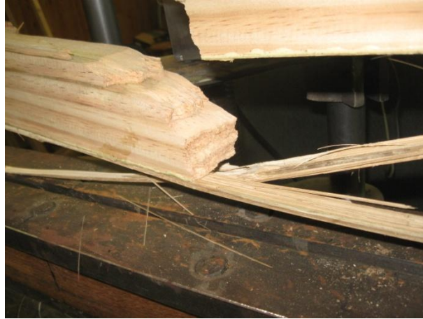
Detalle de falla en la viga VRD.
