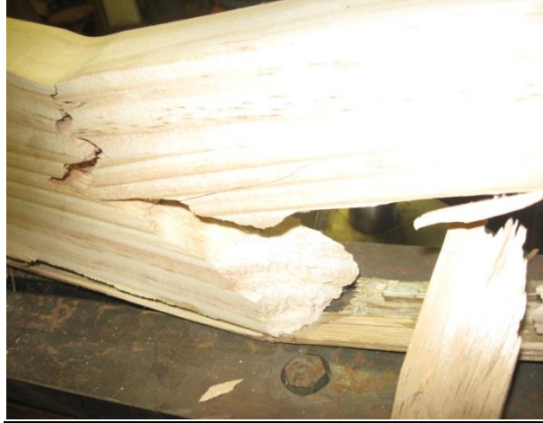
Falla de la viga VRF
