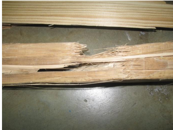
Detalle de la falla en los nudos del refuerzo de bambú.
