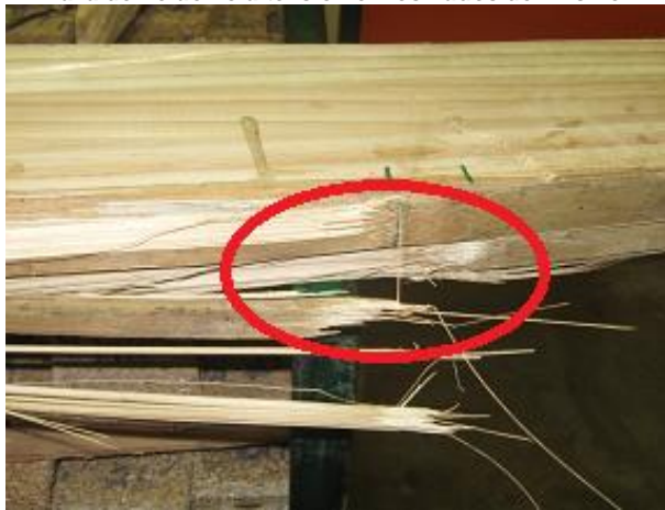
Desprendimiento de fibras en el refuerzo refuerzo
