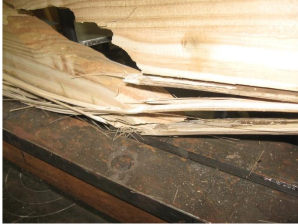
Falla del refuerzo a tensión en los nudos del mismo.
