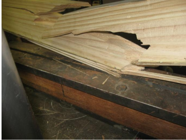
Falla de la viga VRJ.
