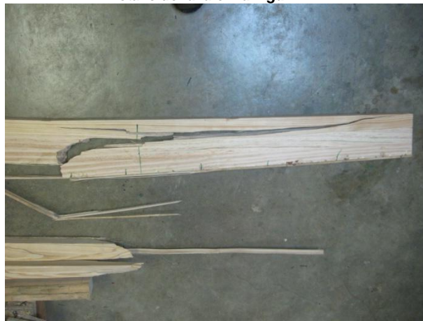
Vista lateral de viga VRD posteriormente a la falla. Se aprecia el punto de origen de la fractura y la propagación de esta.
