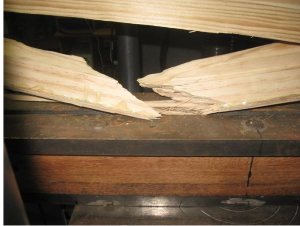
Detalle de la falla de la viga VRC.
