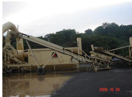
Figura 5. Faja transportadora del agregado desde las tolvas hasta el tambor mezclador.
