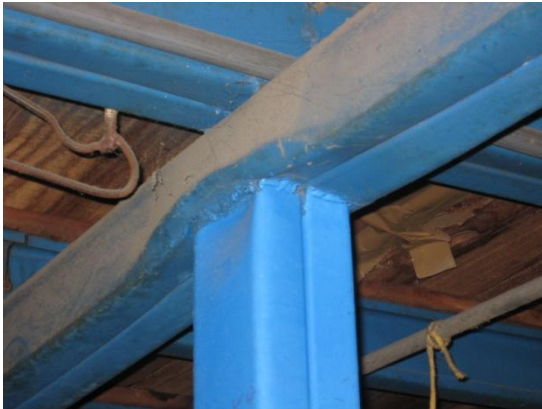
Figura 2. Viga tipo cajón compuesta de perfiles C. Estructura ubicada en bodega industrial, falla evidente en el apoyo. Fotografía cortesía de: Alonso Poveda, 2010.
