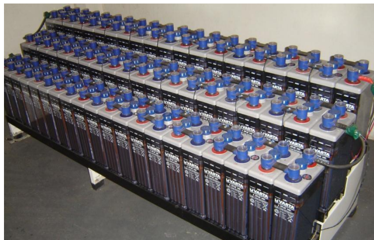
Figura 5.3 Banco de baterías Porrosatí.
