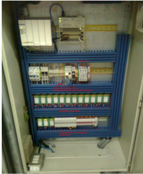
Figura 5.9 Gabinete para sensores.
