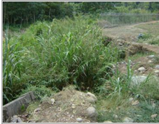
Figura 16. Carencia de malla protectora del sistema de tratamiento de aguas residuales de Pérez Zeledón.
