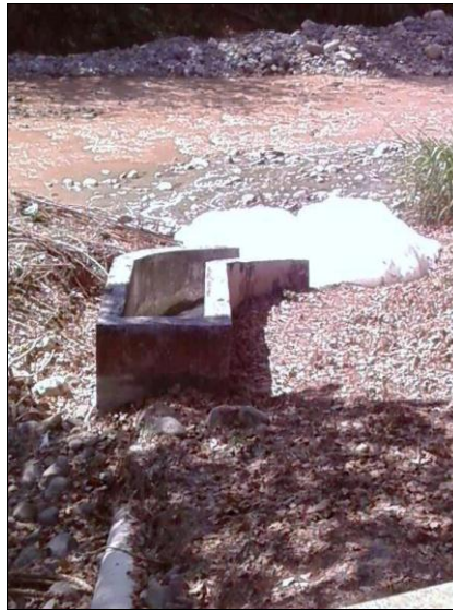
Figura 22. Salida de la planta de tratamiento de aguas residuales de Pérez Zeledón.
