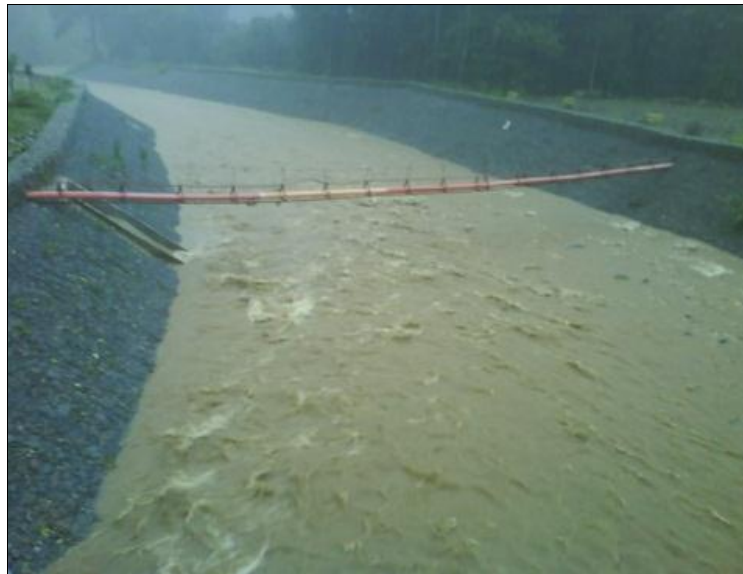
Figura 13. Riesgo del Paso elevado durante lluvias y crecidas del Río San Isidro.
