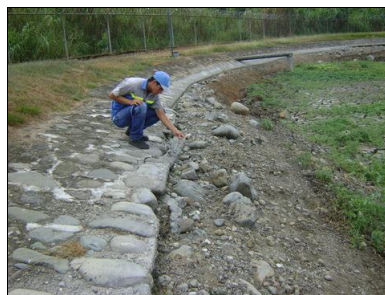
Figura 19. Daños en la infraestructura de las lagunas del sistema de tratamiento de aguas residuales de Pérez Zeledón.
