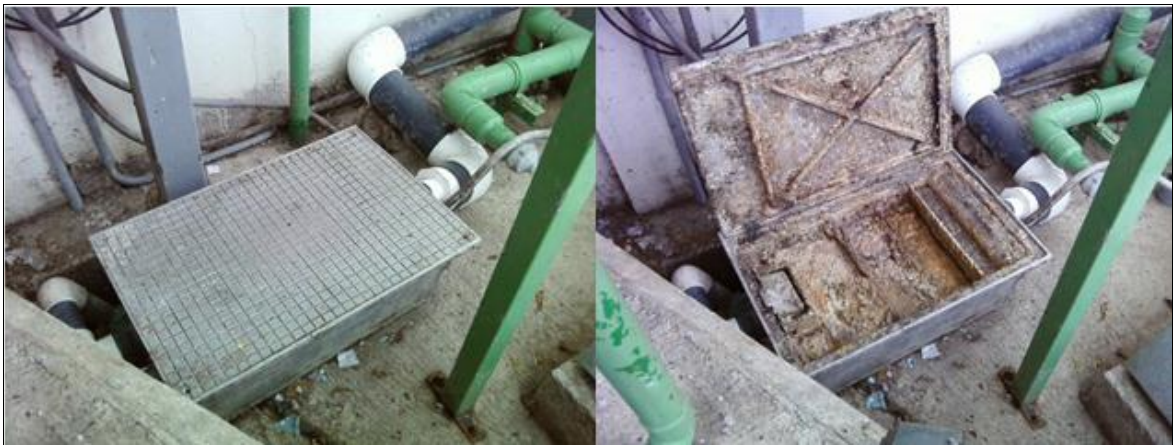
Figura 3. Trampas de grasas del sistema de aguas residuales de los entes generadores.
