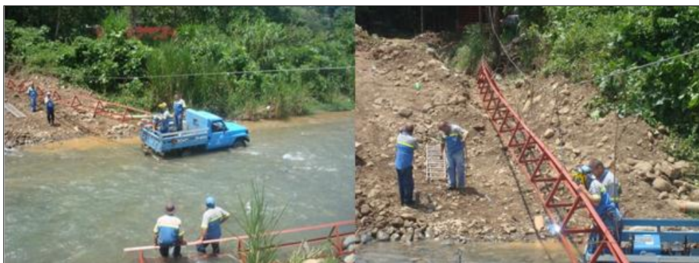
Figura 11. Reparación de averías del paso elevado sobre el río San Isidro en el 2010.
