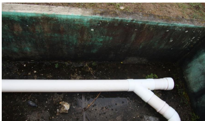
Figura 23. Detalle de la tubería de salida de AR tratadas del FAFA
