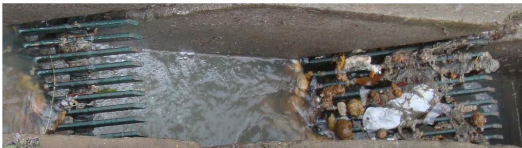
Figura 21. Detalle de la barras del canal de rejillas
