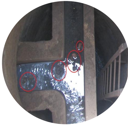
Figura 14. Registro de alcantarillado pluvial (Agosto 2011)
