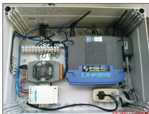
Figura 6.3 Estructura de adquisición de datos presente en la zona de tanques del Edificio CGT
