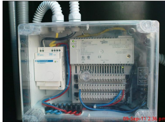
Figura 6.2 Estructura de adquisición de datos presente en uno de los grupos electrógenos SDMO del Edificio Operadoras
