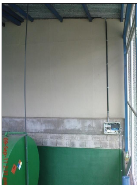
Figura 6.4 Tubería implementada para comunicar los transmisores de presión en los tanques con la estructura de adquisición de datos en la zona del Edificio CGT
