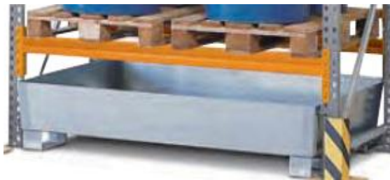
Figura 7.15. Cubeta de contención de derrames
