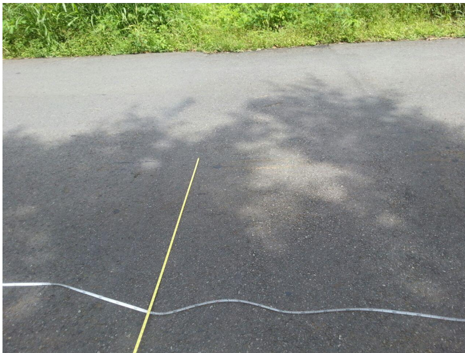
Foto 4. Medición de grietas transversales y longitudinales.
