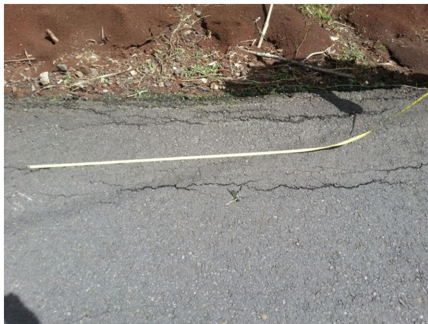
Foto 2. Medición de grietas transversales y longitudinales.
