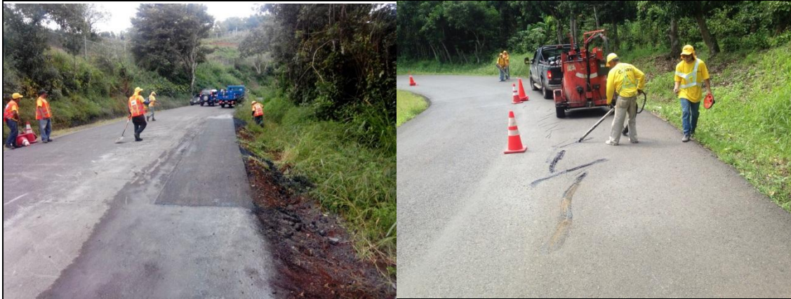
Figura 4.5. Actividades de bacheo formal y sellado de grietas realizadas previo a la colocación de la sobrecapa asfáltica de 5 cm de espesor.
