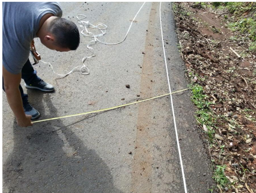
Foto 1. Medición de grietas transversales y longitudinales.
