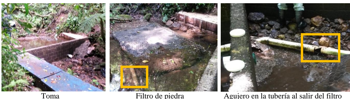
Figura 4.11. Estructura de captación Casa Blanca N°2
