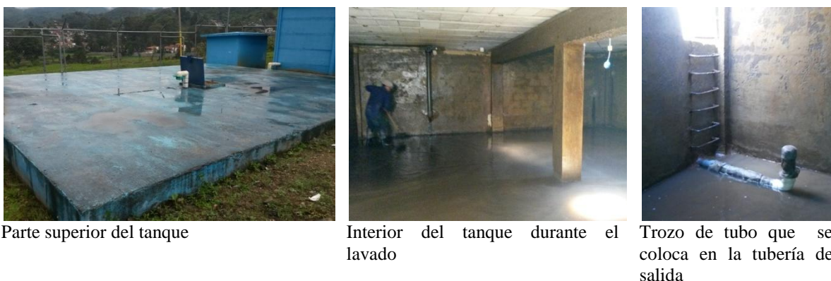
Figura 4.20. Tanque de almacenamiento
