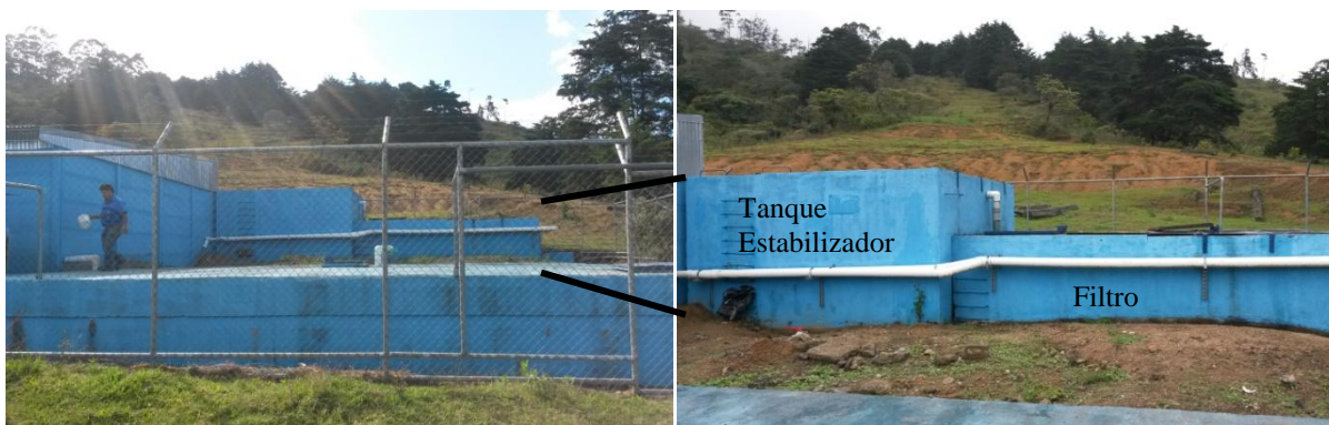
Vista de frente del tanque de almacenamiento, tanque estabilizador y filtro atrás.
