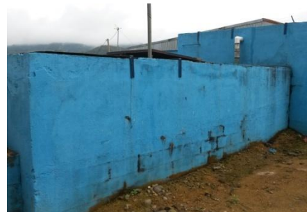
Lateral del filtro con grietas
