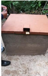
Caja de registro
