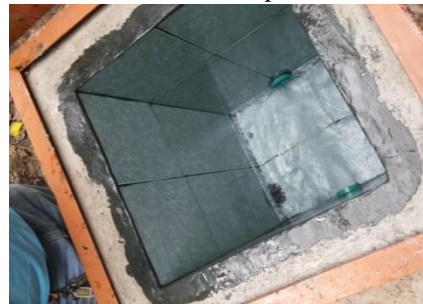
Interior caja de registro
