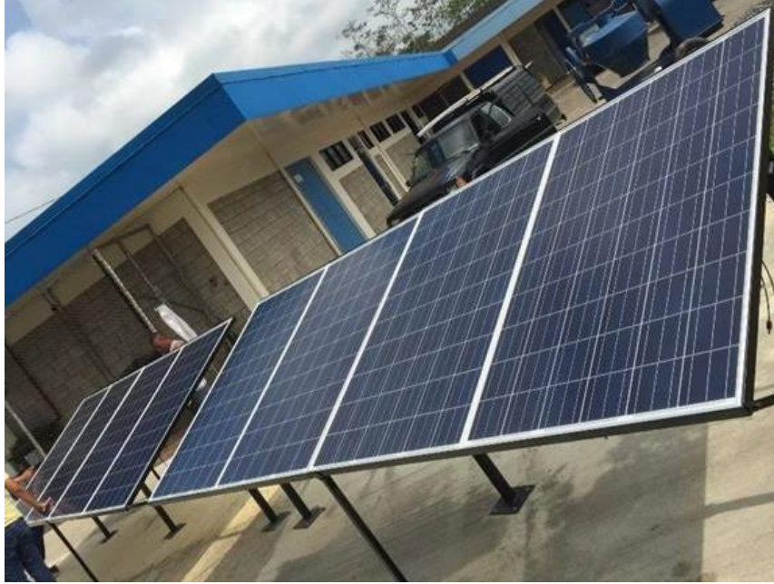
Figura 3. Equipo de paneles fotovoltaicos instalados en la lechería del ITCR sede San Carlos.
