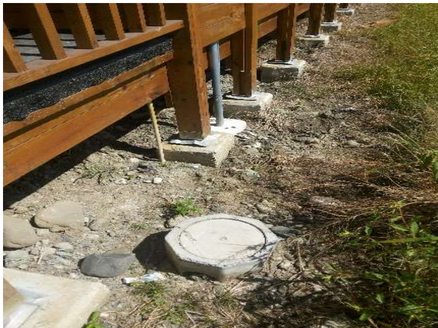
Figura 56, anexo: Sistema de pilotes y las uniones entre las columnas de madera y los cimientos. Fuente: elaboración propia proyecto en Batán, Limón. Empresa Montelimar
