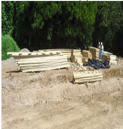
Figura 49. Falta de un adecuado sitio para almacenar la madera. Fuente: elaboración propia
