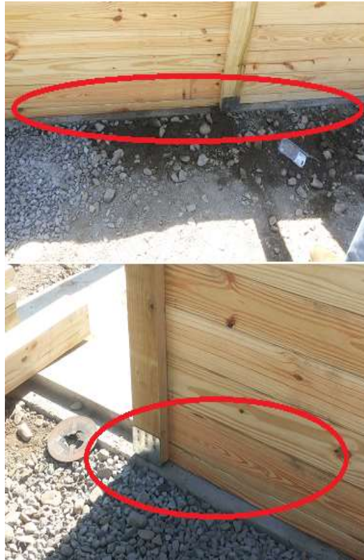
Figura 48. El contacto directo del concreto con la madera. Fuente: elaboración propia
