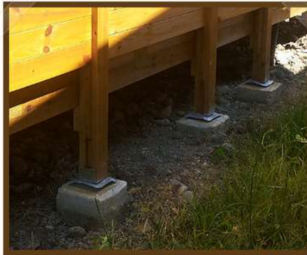
Figura 2. Colocación de protección a las columnas de la vivienda para impedir el paso de los insectos. Fuente: elaboración propia, tomada del proyecto en Batán, Limón de la empresa Montelimar
