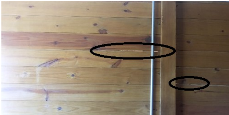
Figura 55, anexo: Se observa un problema de separación entre los paneles que forman la pared. Fuente: elaboración propia proyecto en Batán, Limón. Empresa Montelimar
