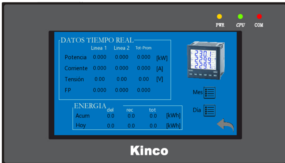
Imagen 4.35. Pantalla de monitoreo del medidor de energía.
