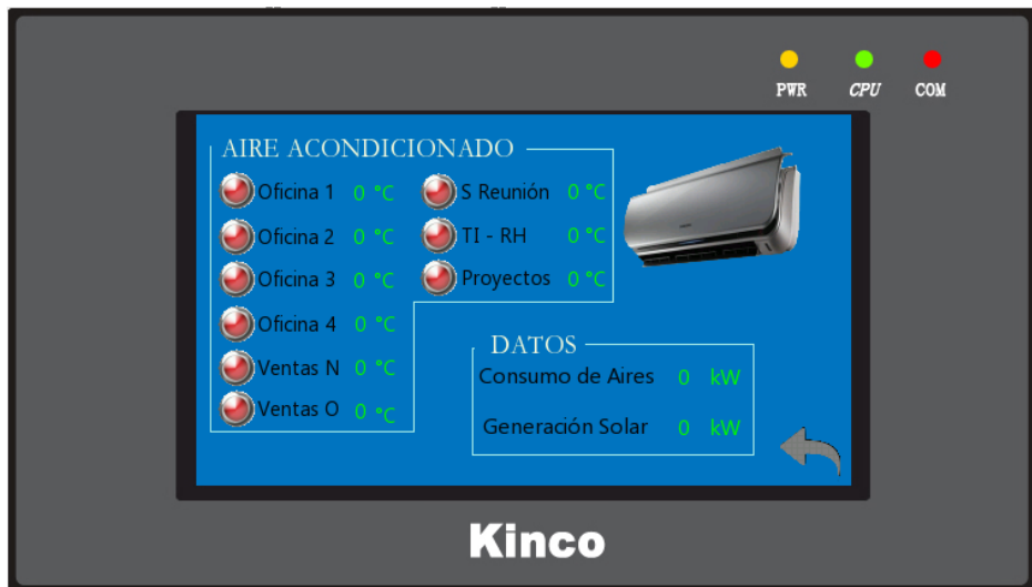
Imagen 4.33. Pantalla de control y monitoreo de aires acondicionados.
