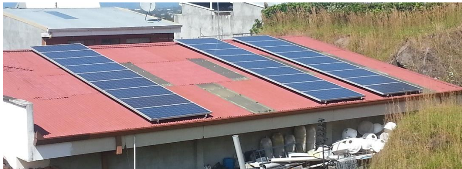
Imagen 4.3. Paneles solares en Siesa
