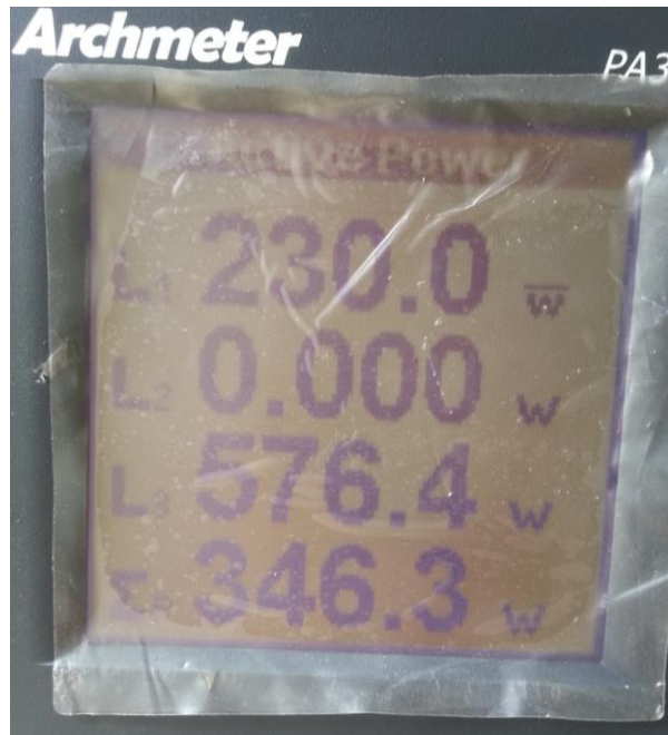
Imagen 4.6. Líneas desbalanceadas, vista de medidor PA3000
