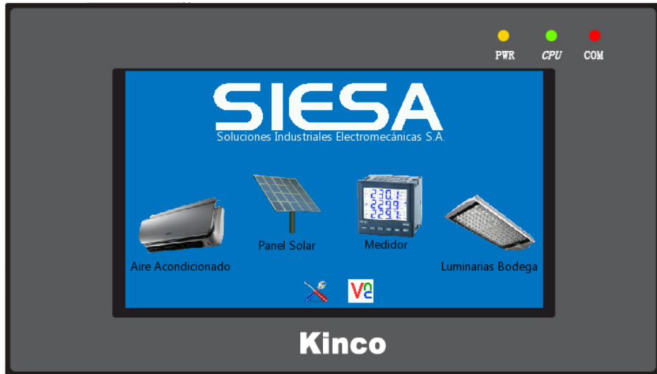
Imagen 4.32. Pantalla principal del sistema SCADA.
