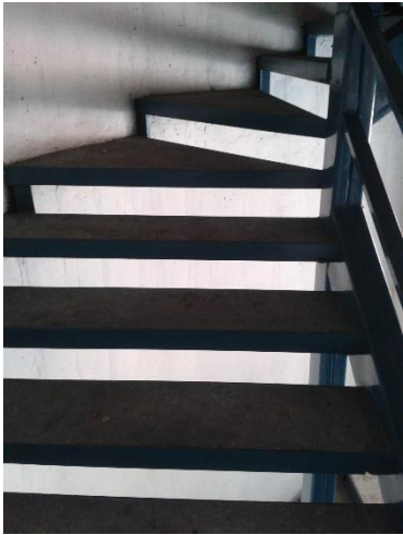
Aberturas en las contrahuellas de las escaleras de los medios de egreso
