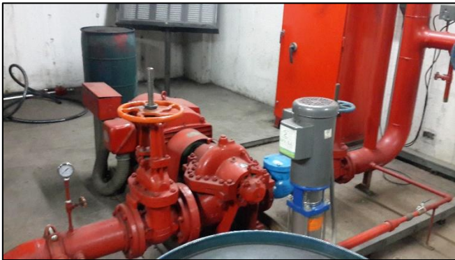
Bomba contra incendio
