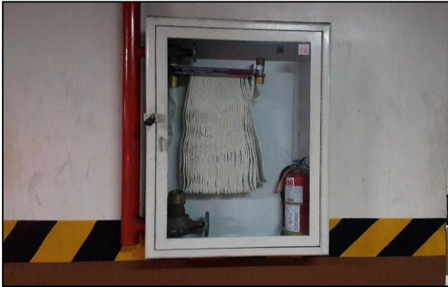
Gabinete y extintor
