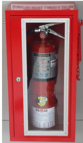
Figura V-20: Instalación de extintores portátiles
