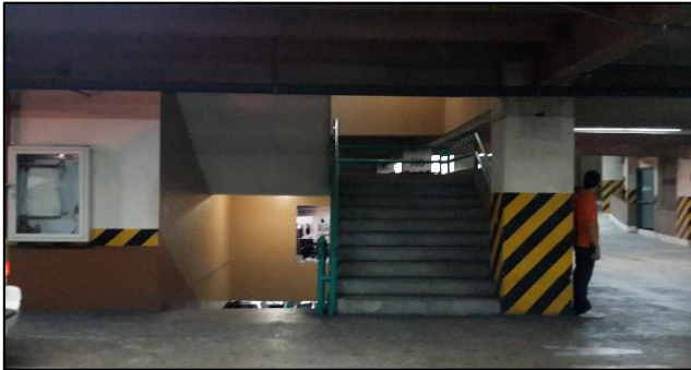
Escaleras de servicio sin compartimentación
