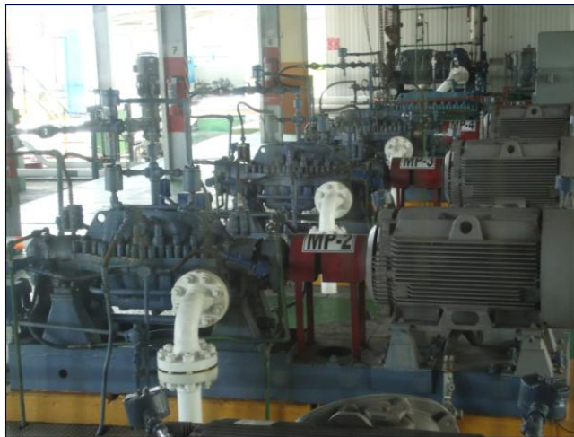
Figura A.2.2 Motores trifásicos y bombas del sistema de bombeo.
