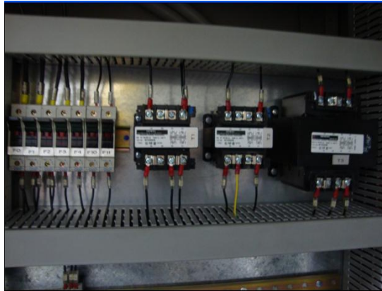
Figura A.2.3 Transformadores de medición y transformador de control instalados en el sistema de arranque.
