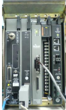
Figura A.2.1 Rack utilizado con el PLC, fuente de 24V DC , y módulos mencionados en el informe.
