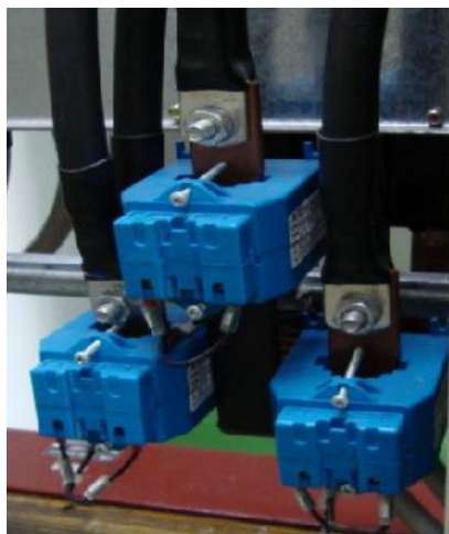
Figura A.2.5 Transformadores de corriente FRER de 600A/1A.
