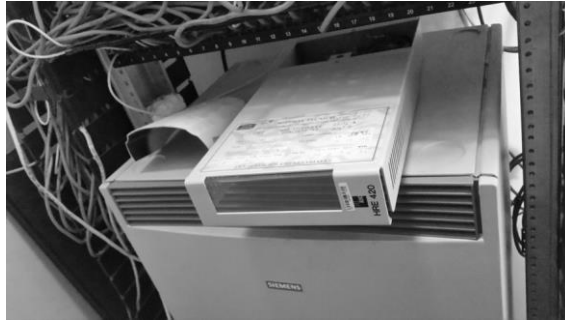
Fig. 3. PBX Siemens actual.
