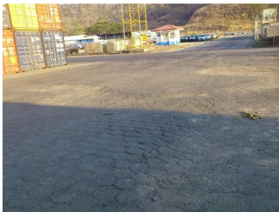
Figura 16. Estado actual del pavimento en la zona #2. Fuente: Elaboración propia.
