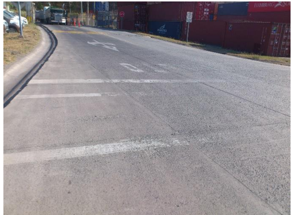
Figura 19. Estado de la señalización en la intersección 6. Fuente: Elaboración propia.
