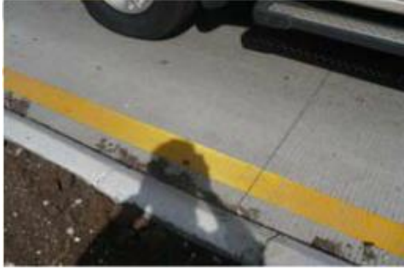
Figura 7. Pintura con mala reflectividad. Fuente: (REFLECTA-Señalización Efectiva, 2013).
