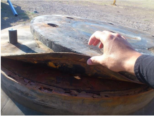
Figura 12. Cono de la defensa marina deteriorada. Fuente: Elaboración propia
