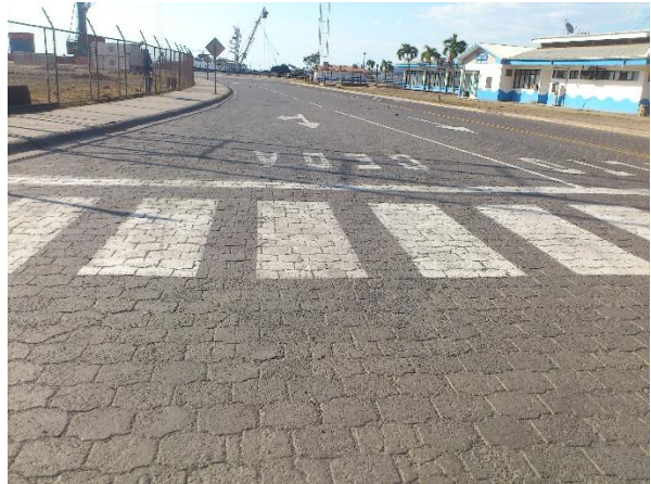
Figura 18. Estado de la señalización en la intersección 2. Fuente: Elaboración propia.
