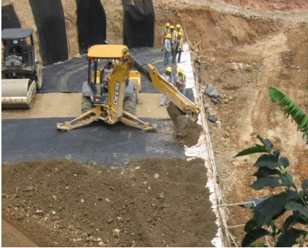
Figura 48. Colocación y extendido del material de relleno en el borde de la cara externa del muro. (PH Pirris, 2011)
