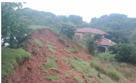
Figura 2. Fotografía parcial del colapso del terreno en la propiedad ubicada en la zona de Dominical.
