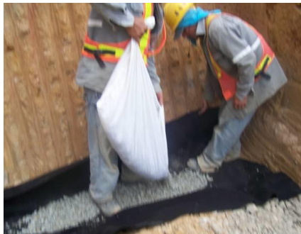
Figura 19. Separación del material de relleno del drenaje interno y el material de sitio. (PH Pirrís, 2011)
