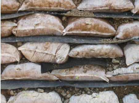
Figura 41. Capas del muro de suelo reforzado cada 20 cm de separación vertical. (PH Pirris, 2011)
