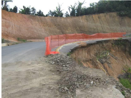
Figura 22. Ruta para los vecinos hacia otros sectores de la zona. Pone en peligro sus vidas el colapso de la acera. (PH Pirrís, 2011)
