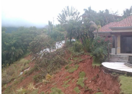
Figura 23. Colapso parcial del talud de la propiedad privada. (Dominical 2011)
