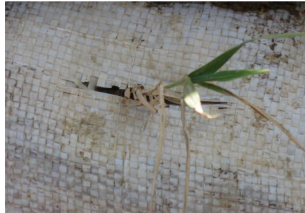
Figura 52. Saco de fachada externa del muro cuando empieza a vegetar. (PH Pirris, 2011)
