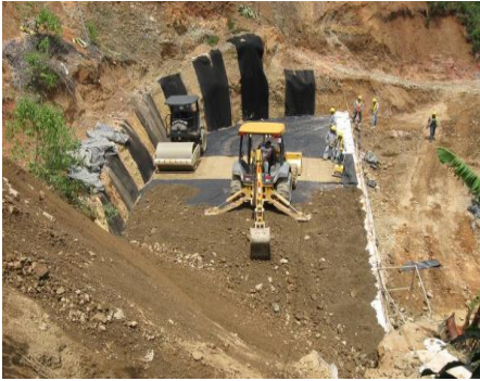
Figura 49. Extendido del material de relleno sin dañar el geotextil tejido. (PH Pirris, 2011)
