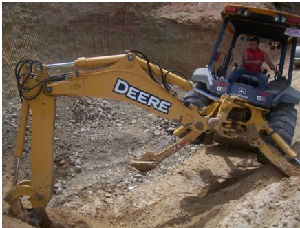
Figura 34. Movimiento de tierra previo para obtener la geometría del muro mediante una retroexcavadora.(PH Pirris, 2011).
