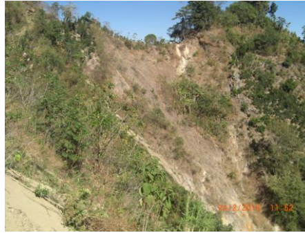
Figura 11. Deslizamiento izquierdo del camino Higuerón-San Antonio. Talud de 100m de altura aproximadamente. (Elaboración Propia, 2015)
