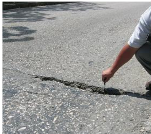
Figura 6-4 Sobrecapas en el pavimento (grado 5)
