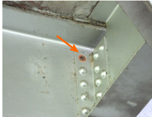
Figura 6-21 Pérdida de pernos
