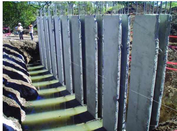
Figura 38 Bastión prefabricado (www.puenteprefa.cr)
