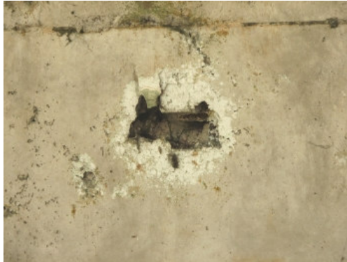
Figura 6-31 El acero de refuerzo está expuesto dentro de la cavidad
