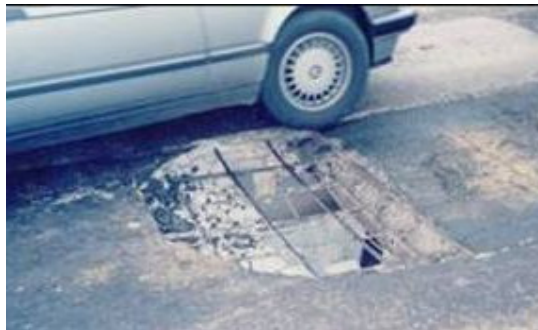
Figura 6-19 Agujero en la losa (grado 5)
