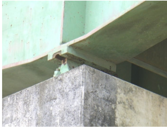
Figura 6-37 Movimiento del apoyo (grado 5)
