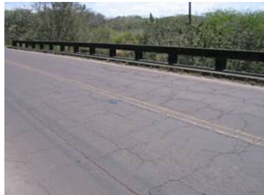
Figura 6-2 Grietas en el pavimento (grado 4)
