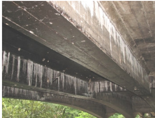
Figura 6-32 Eflorescencia en la viga principal (grado 4)
