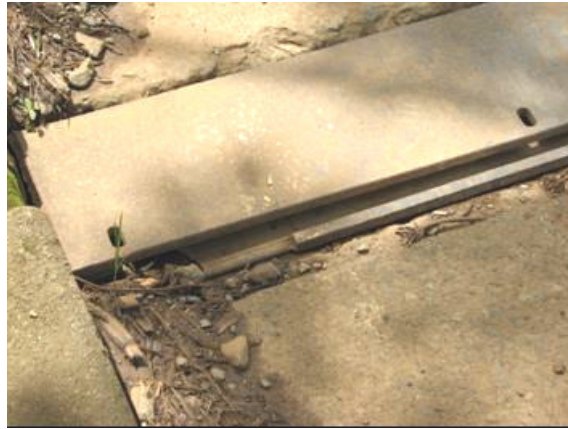
Figura 6-12 Movimiento vertical de la junta de expansión
