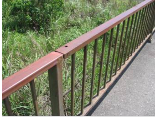
Figura 6-7 Corrosión en la baranda de acero (grado 3)
