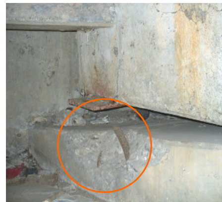
Figura 6-34 Pernos de anclaje cortados
