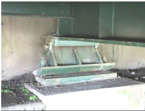
Figura 6-36 Inclinación del apoyo (grado 5)
