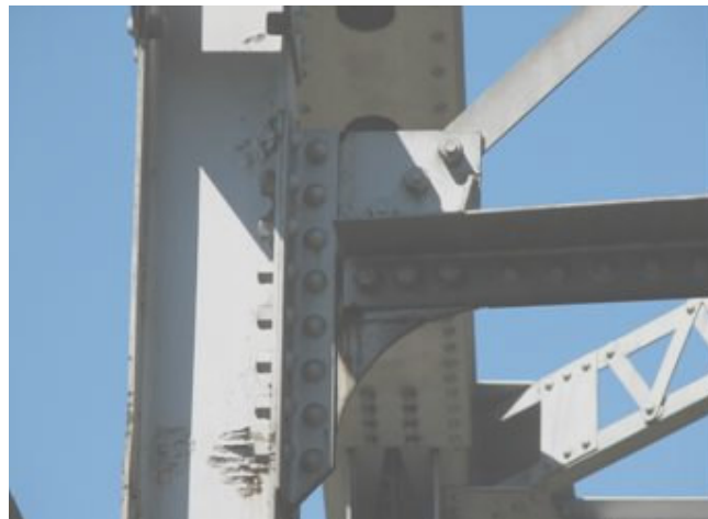
Figura 6-27 Descascaramiento de la pintura en la estructura (grado 3)
