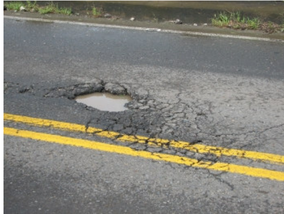
Figura 6-3 Baches en el pavimento (grado 2)
