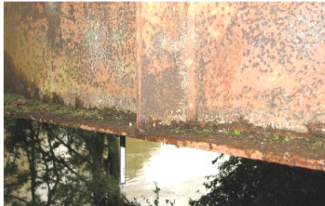
Figura 6-20 Oxidación en la viga principal
