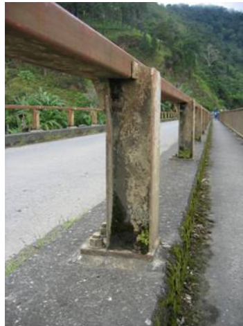
Figura 6-6 Oxidación (baranda de acero)
