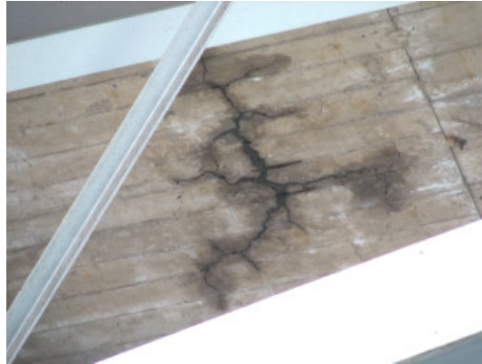
Figura 6-15 Grietas en dos direcciones
