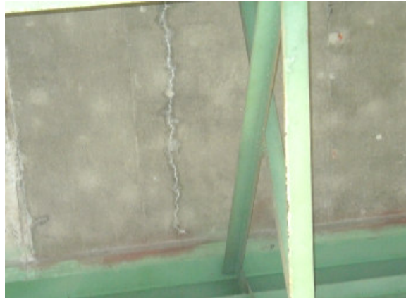
Figura 6-14 Grieta en una dirección en la losa
