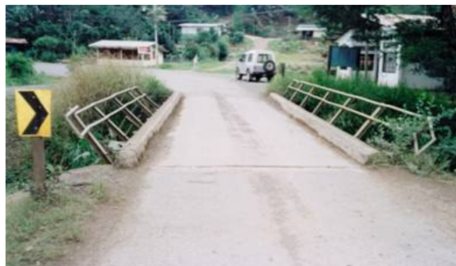
Figura 6-5 Deformación de la baranda (grado 5)
