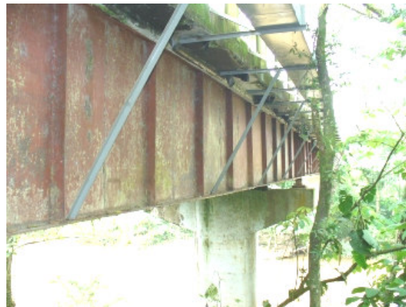
Figura 6-26 Decoloración de la viga principal
