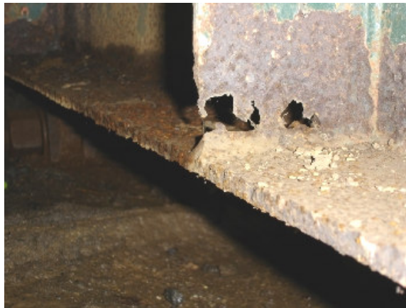
Figura 6-24 Corrosión del atiesador vertical (grado 5)
