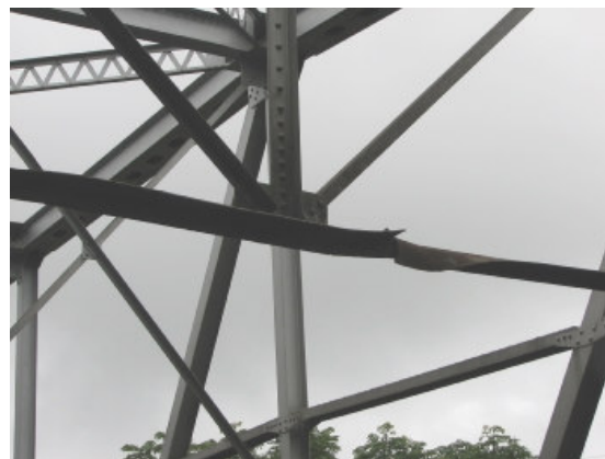
Figura 6-25 Rotura del elemento inferior del diafragma superior (Grado 3)
