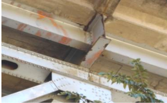
Figura 6-23 La oxidación comienza en el borde filoso (grado 3)
