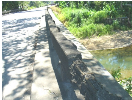
Figura 6-9 Acero de refuerzo expuesto (baranda de concreto)
