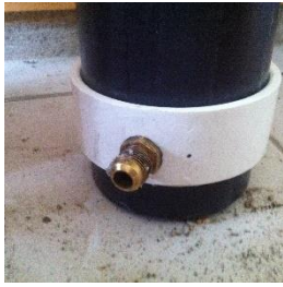
Entrada de gas a filtro
