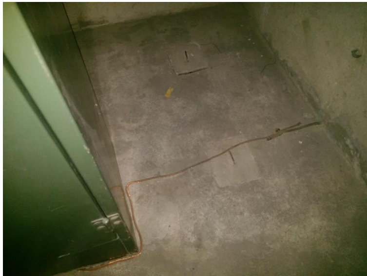
Figura 3.12. Cable de puesta a tierra
