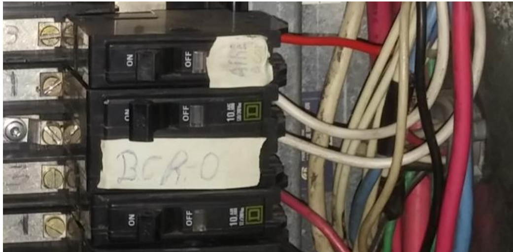
Figura 3.5. Circuito ramales del tablero ubicado en el cuarto de la planta de emergencia.
