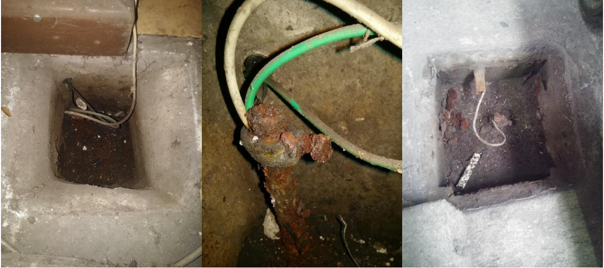
Figura 3.13. Puesta de tierra adicional.
