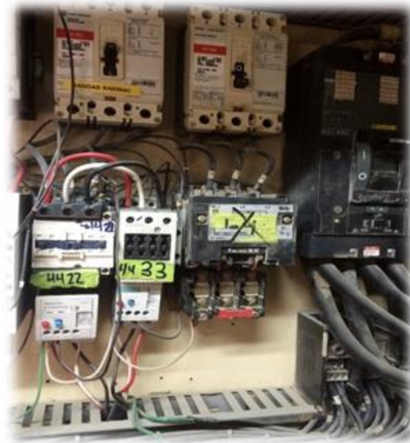
Figura IV-1 Fotografía de protecciones eléctricas de algunos motores de Planta Guápiles
