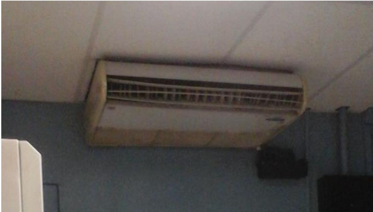
Figura 11. Minisplit de Banco de sangre en mal estado.
