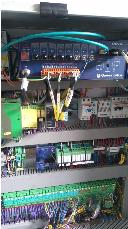
Figura A7.6 Arduino Instalado en Aerogenerador 6 Fuente: Fotografía Propia
