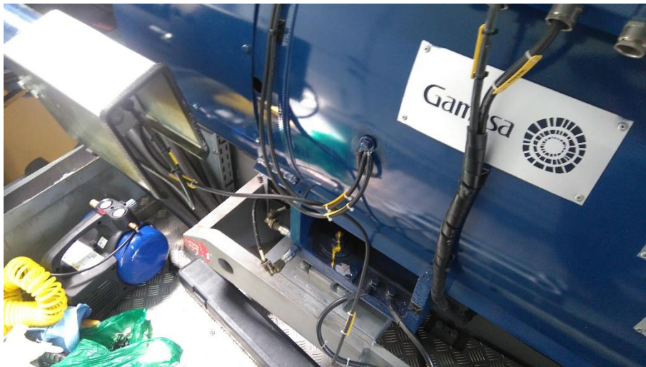
Figura A4.1 Sensores Acelerómetros en el Generador en posición axial y horizontal
