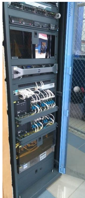
Figura 6.12 Servidor Actualmente instalado en el edificio de O&M
