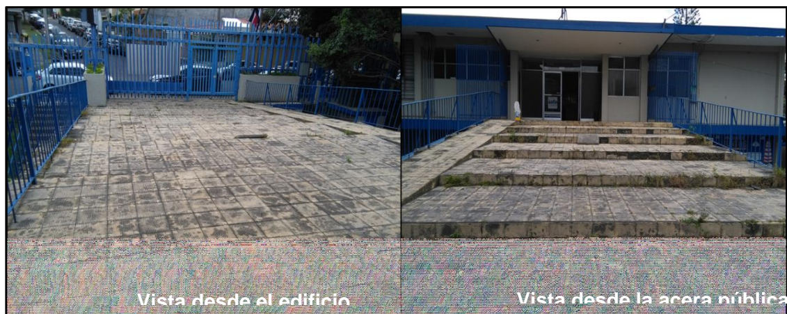
Figura V.13. Espacio en desuso que comunica el tercer piso del edificio con la acera pública
