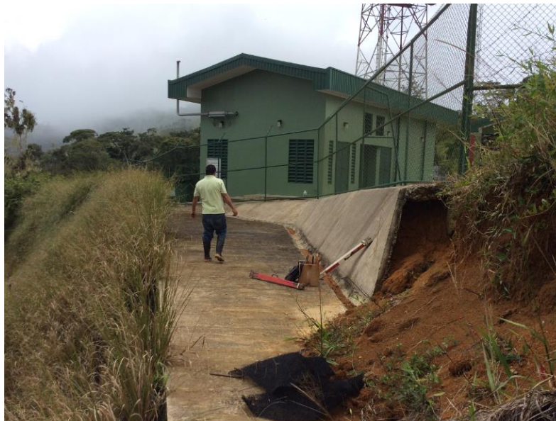
Figura N° 7. Colindancia del talud en condiciones de deslizamiento con la Central. Solución provisional de Vetiver en el primer talud
