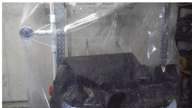
Figura 31. Bandeja cubierta mientras se estabiliza la presión en el sistema.
