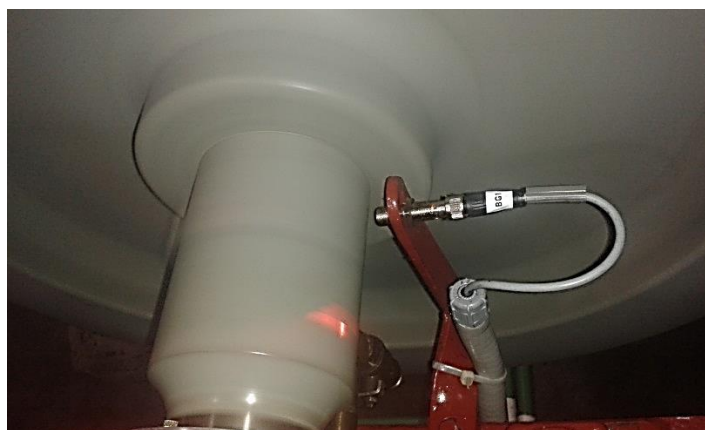
Figura 69. Instalación de sensor inductivo (Fuente: Fotografía en la micro central).
