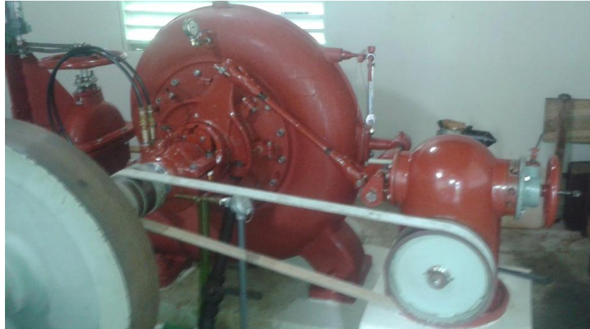
Figura 3. Comunicación de velocidad entre el gobernador y el eje de la turbina mediante una faja (Fuente: Fotografía en la micro central).
