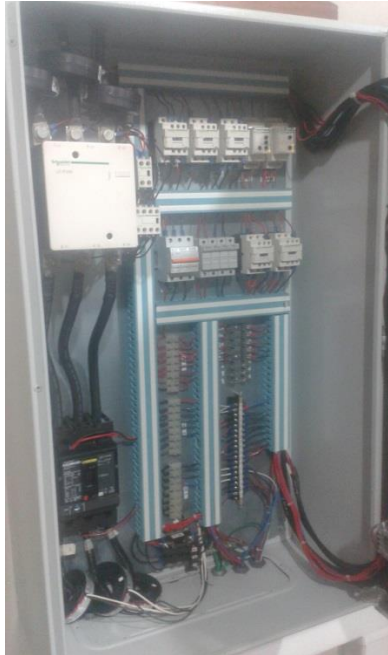
Figura 2. Panel de potencia de la micro central hidroeléctrica La Rebeca de La Marina (Fuente: Fotografía en la micro central).
