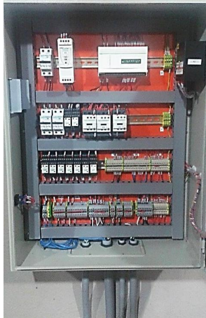
Figura 66. Distribución final de los equipos en el panel (Fuente: Fotografía en la micro central).
