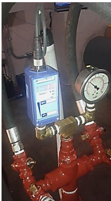
Figura 68. Conexión del sistema de monitoreo de presión en la bomba hidráulica (Fuente: Fotografía en la micro central).
