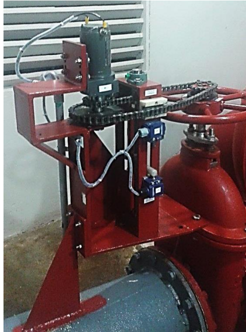
Figura 67. Automatización de la válvula principal (Fuente: Fotografía en la micro central).
