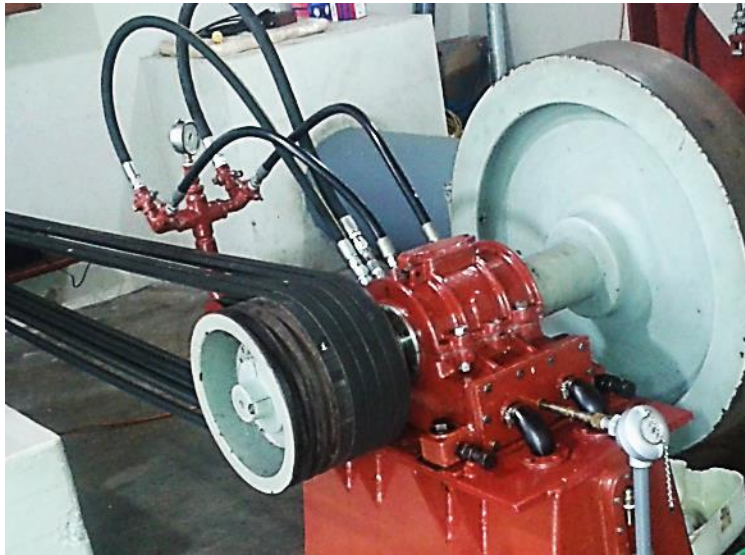
Figura 19. Manómetro de la bomba hidráulica instalado previo a la automatización (Fuente: Fotografía en la micro central).
