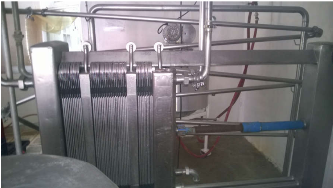
Figura 6 Intercambiador de placas de la planta. Tomada por: Diego Elizondo.
